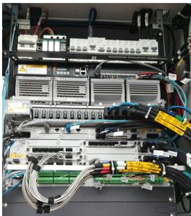
Figura B 42. BBU Instalado en gabinete TP48200.
