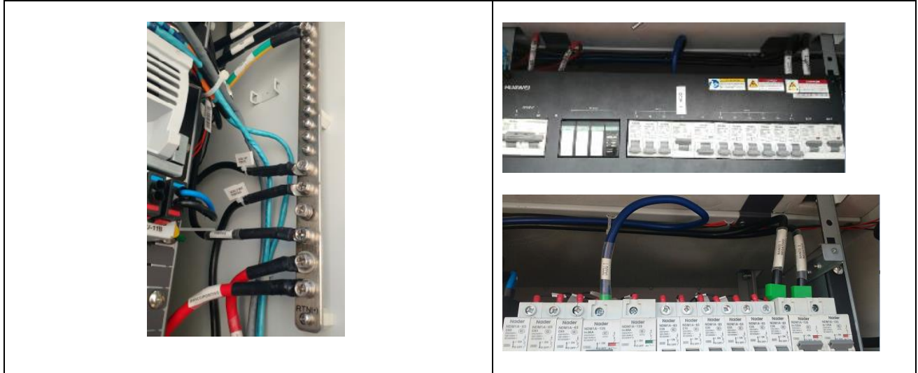
Figura B 14. Instalación e interconexión de banco de baterías en gabinete TP48200.
