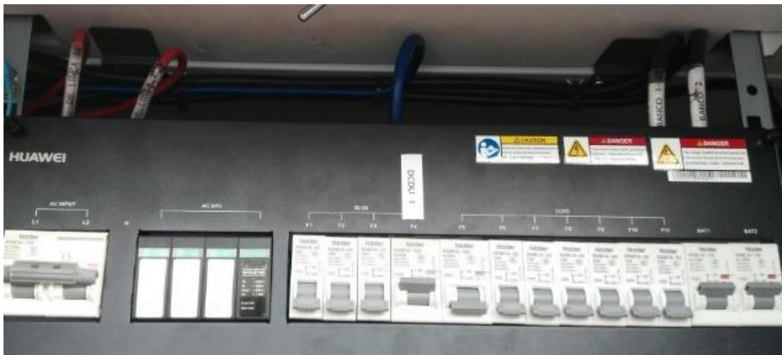
Figura B 23. Identificación de cables Banco 1, Banco 2 y Breakers de Baterías en gabinete TP48200.
