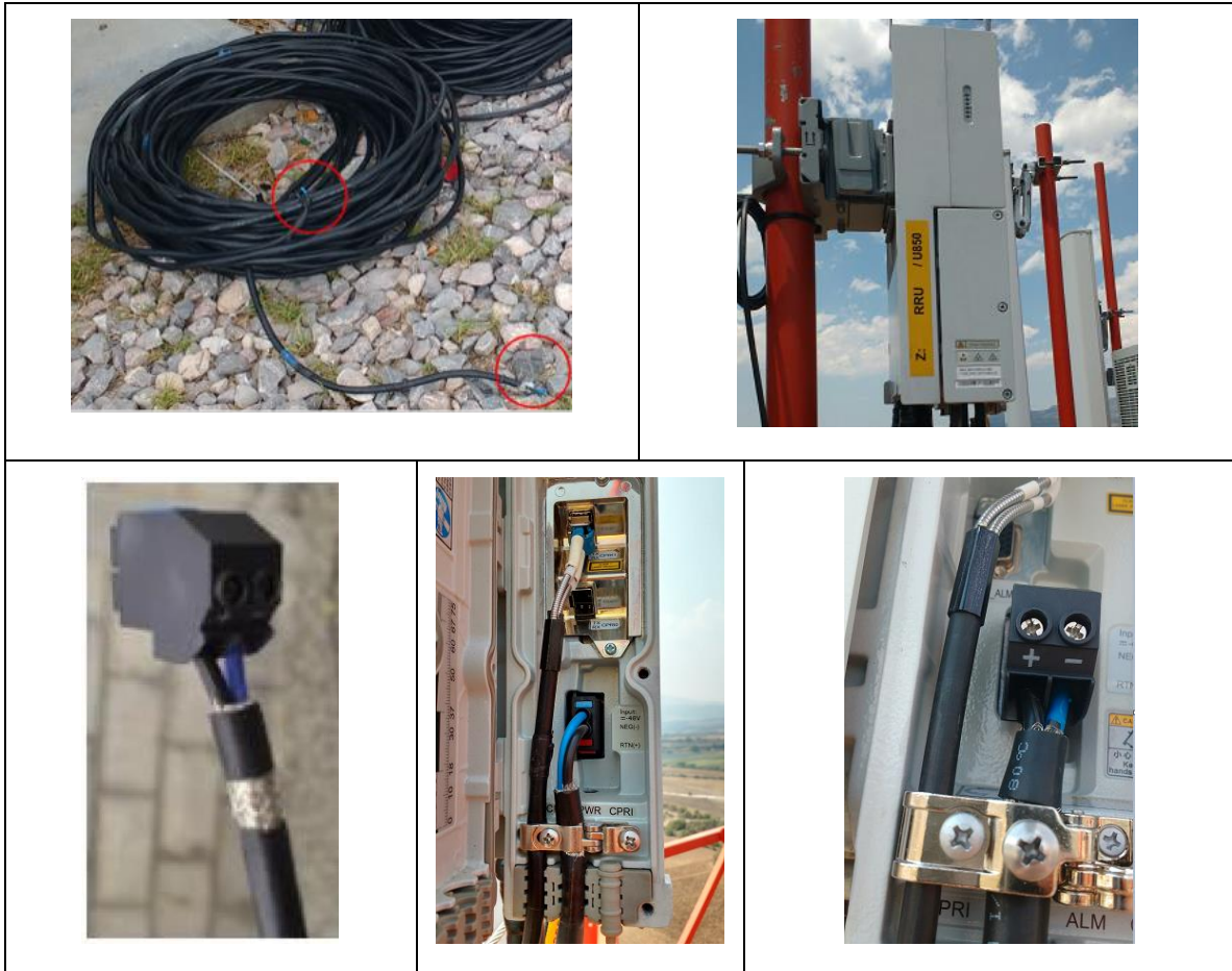
Figura B 57. Instalación de VCD y puesta a tierra de RRU por medio de la malla de cable de alimentación DC
