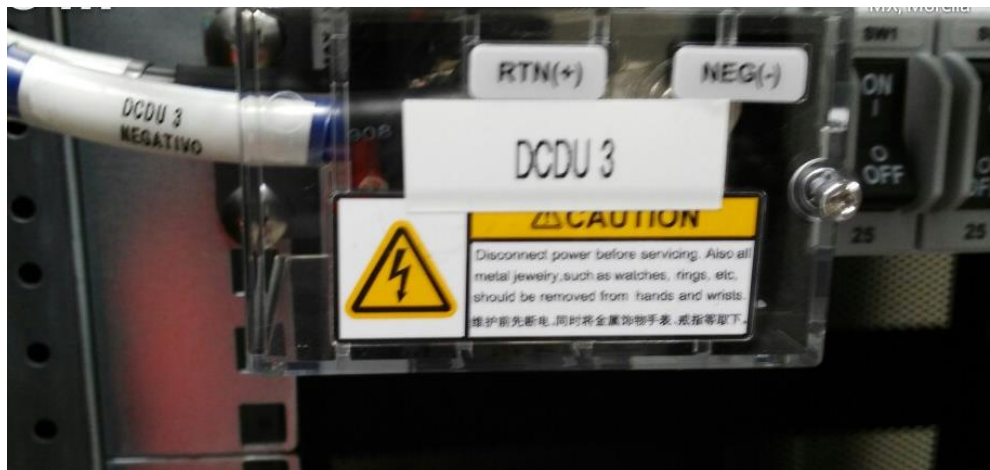
Figura B 40. Instalación de DCDU en gabinete TP48200.
