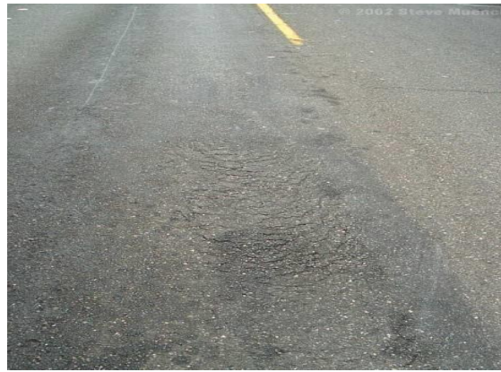
Fig. 2-7 Grietas de deslizamiento (Interactive, 2009)
