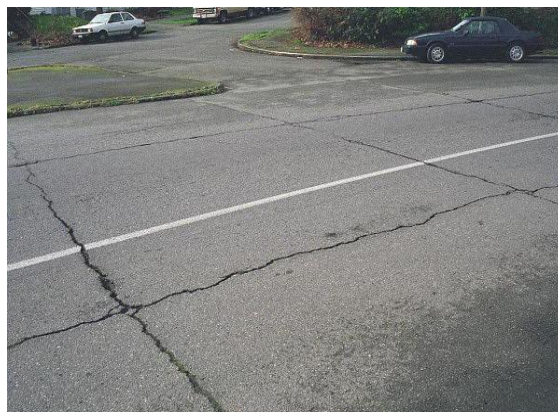
Fig. 2-6 Grietas reflejadas (Interactive, 2009)
