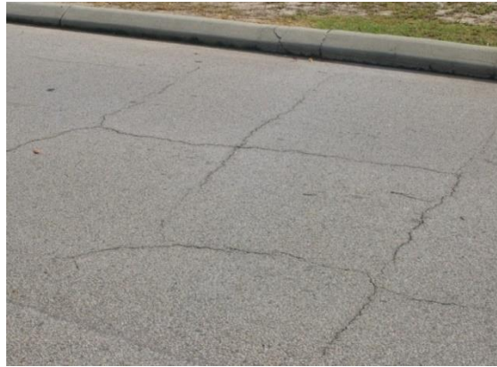
Fig. 2-5 Grietas en bloque (Interactive, 2009)
