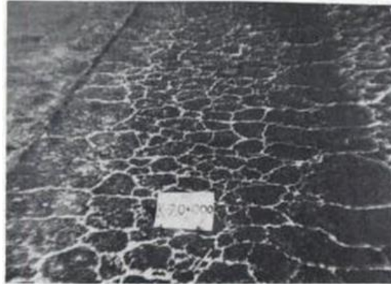
Fig. 2-3 Agrietamiento por fatiga tipo piel de cocodrilo (Rico & Del Castillo, 1978)
