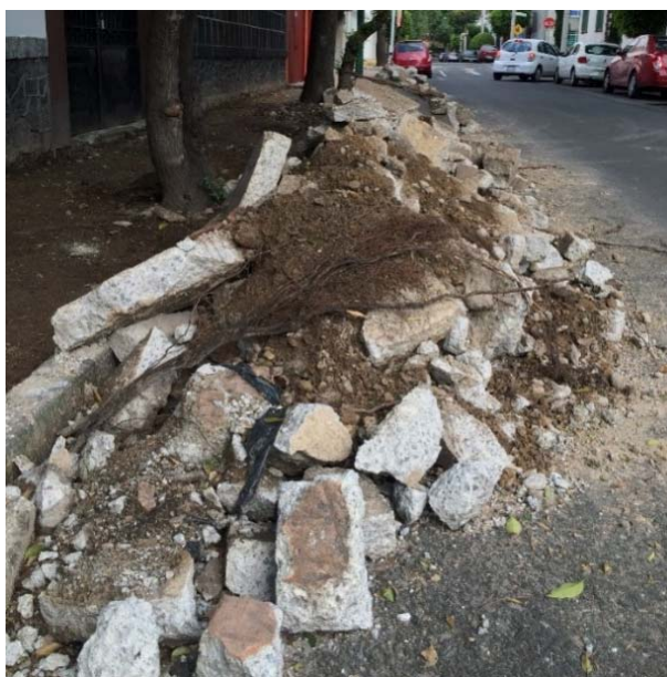
Figura 3. Residuos de construcción sin tratamiento de separación
