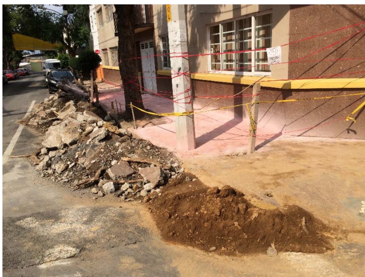
Figura 2. Residuos de Construcción almacenados incorrectamente
