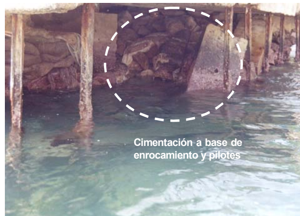
Figura. 3.6.- Socavación bajo el muelle existente
