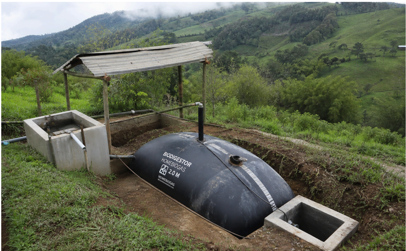
Figura 11.10 Biodigestor en zona rural. El agua tratada se utiliza para el riego de la agricultura y el gas generado permite ahorrar energía eléctrica al agricultor. Imagen ilustrativa.
