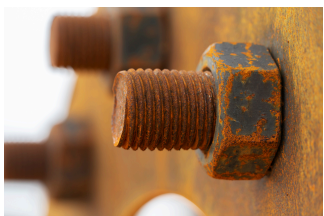
Figura 4.16 Elegir materiales que sean resistentes a la corrosión es importante si la pieza que se fabrica estará expuesta al ambiente.
