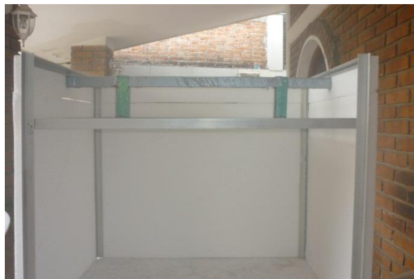
Figura 32. Ducto de alimentación y distribución
