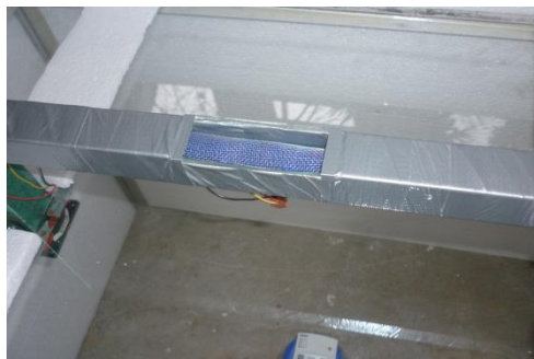
Figura 30b. Sílica gel instalada dentro del ducto de ventilación
