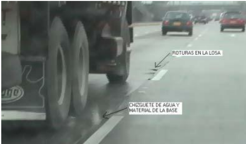
Foto 3.8.b.1 Bombeo en pavimento rígido.
