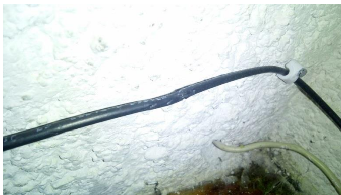
Figura 43. Cable de fibra óptica roto
