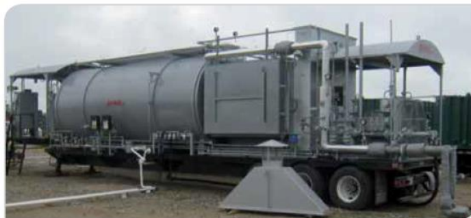
Figura 3.8 Generador de vapor utilizado en la prueba piloto.
