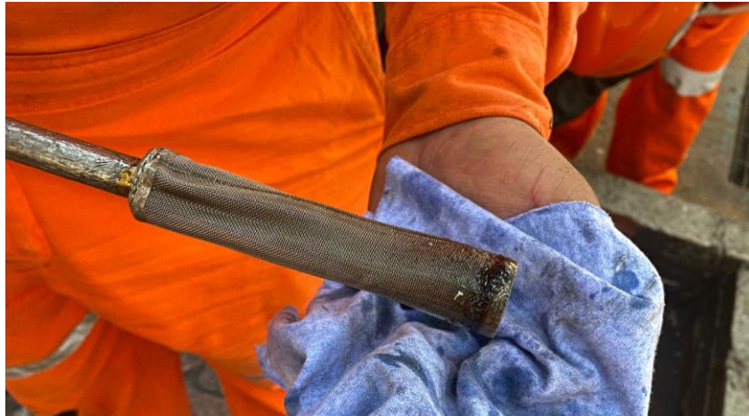
Figura 17. Filtro sucio que se encuentra en interior de la caja azul.
