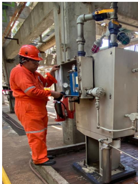
Figura 21. Operario limpiando generador auxiliar.
