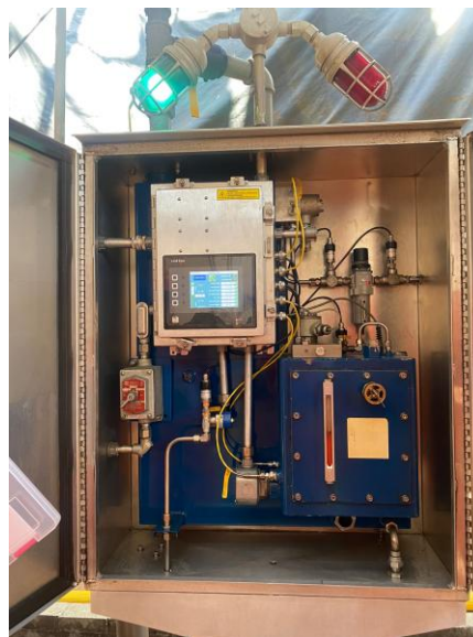
Figura 4. Consola principal Generadora de niebla Modelo SSV.
