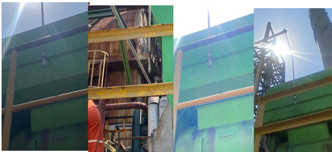
Figura 14. Manifolds en diversas bombas.
