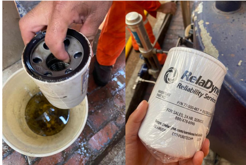
Figura 19. Filtro principal sucio a la izquierda y nuevo antes de sustituir.
