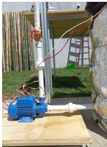
Figura 3.14 Prueba de funcionamiento del circuito experimental
