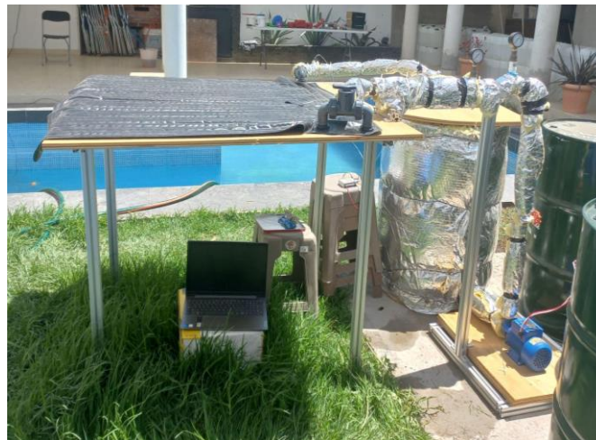
Figura 3.35 Sistema termosolar con equipo de adquisición de datos.
