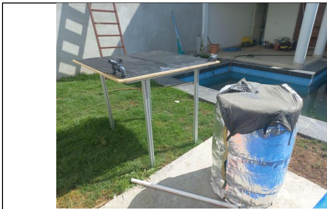
Figura 3.10. Elementos principales: Colector solar y tanque de almacenamiento
