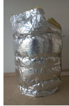
Figura 3.6 Tanque de almacenamiento con recubrimiento de fibra de vidrio con aluminio.
