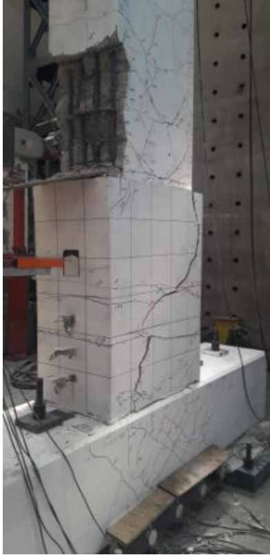
Figura 30. Conexión rehabilitada a una distorsión de 4.6%.
