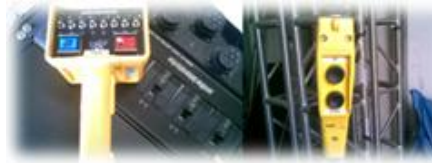
Fig. 11. Control de Motores
