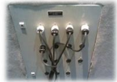
Fig.7. Tablero de abastecimiento Energético
