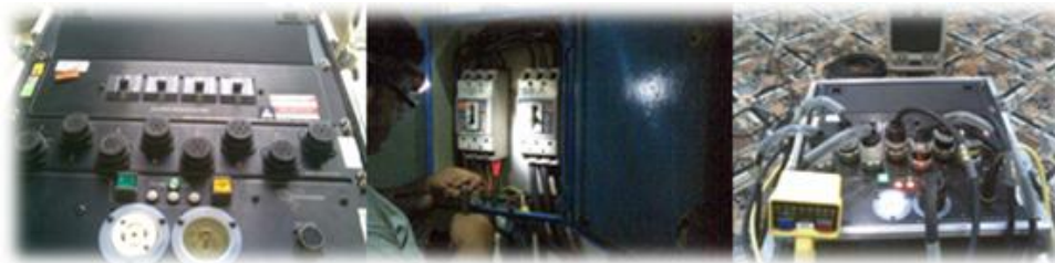
Fig. 12. Suministro eléctrico para el centro de carga de los motores
