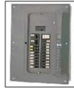
Fig. 9. Centro de carga fijo
