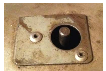
Figura d.2 parche de acero para evitar desgaste por vibración
