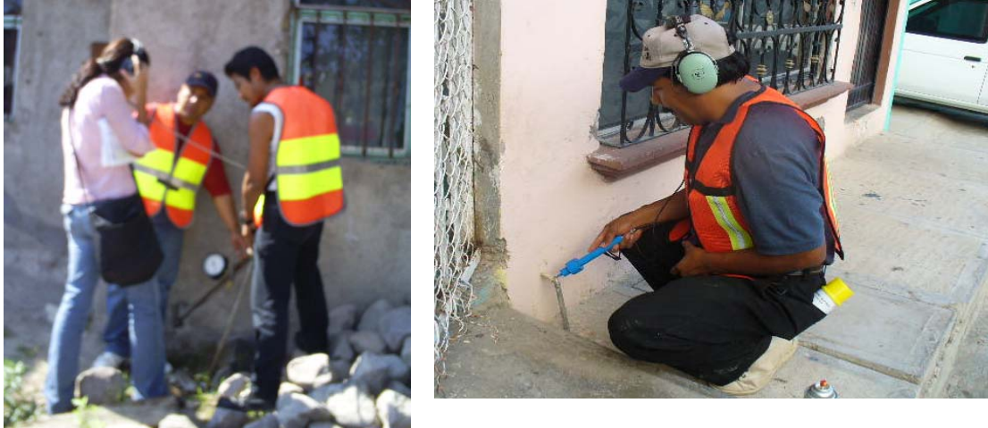
Figura 3.14. Detección de fugas no visibles con equipos electroacústico de detección directa, en tomas domiciliarias
