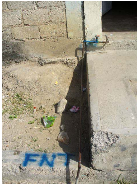
Figura 3.16. Ejemplo Usuario que presenta fuga no visible y además no tiene medidor y estaba accesible para los trabajos de detección en Colonia Santa Fe, calle Talpa no. 28
