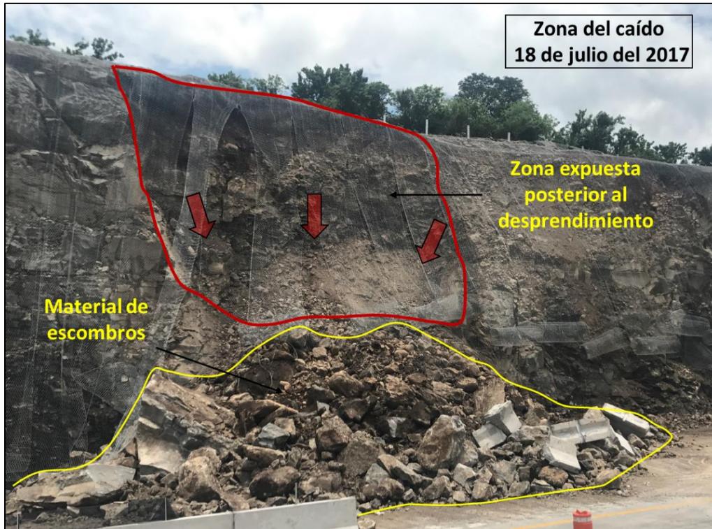
Figura 1.7 Zona del caído posterior al deslizamiento km 41+250.
