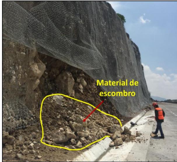
Figura 4.15 Escombros acumulados sobre la berma y bloque de caliza desprendido
