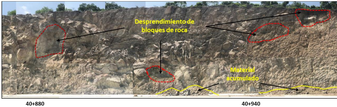
Figura 1.4. Mosaico fotográfico del talud, donde muestran desprendimientos de bloques de roca.
