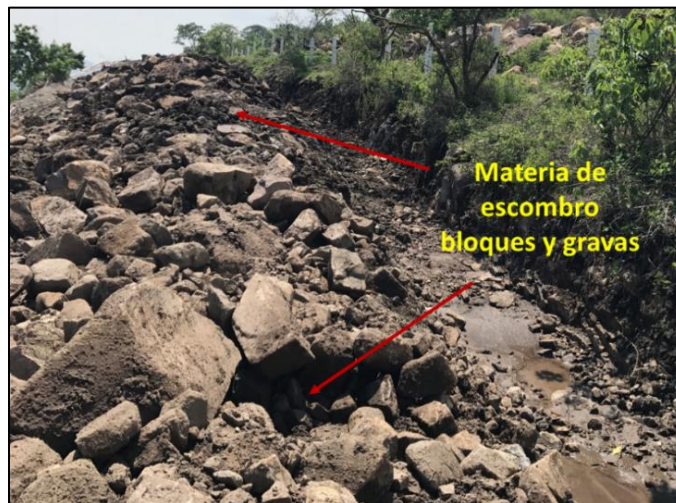
Figura 4.14 Acercamiento al material de escombros en la porción superior del talud.
