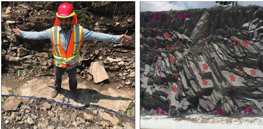
Figura 4.17 Familias de fracturamiento en la porción alta y baja del talud (F1, F2, F3 y F4)
