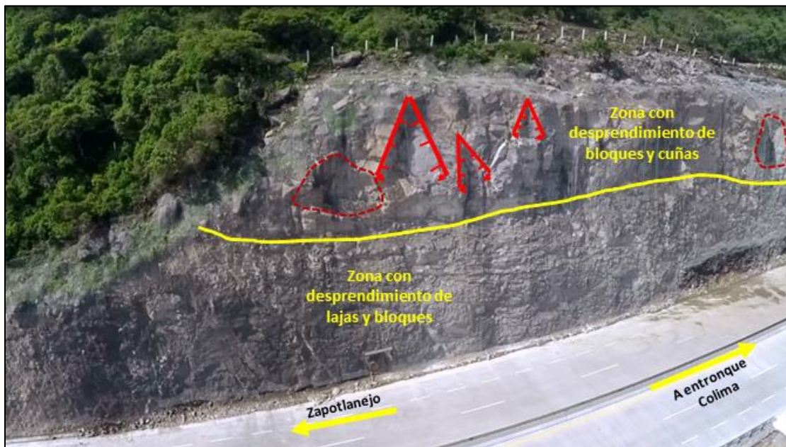
Figura 1.5 En el tramo intermedio y final se observan varias cuñas de roca que se desprendieron del talud, principalmente en la parte superior debido al grado y características de fracturamiento.
