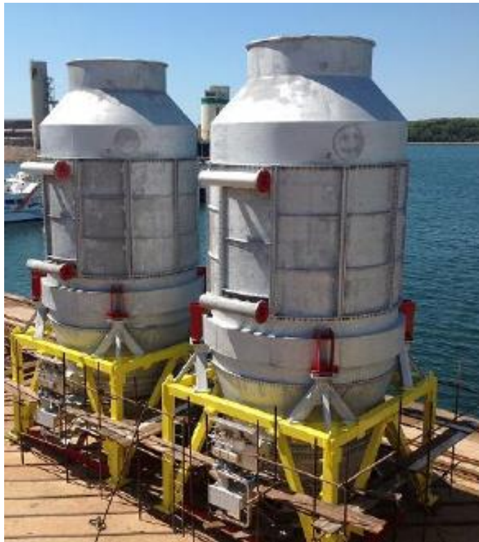
Figura 4.20 Unidades de recuperación de calor (Cameron, 2015).
