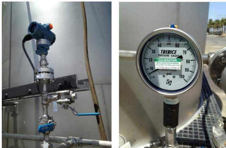
Figura 4.5 Indicadores de presión en sistema de inyección de químicos.
