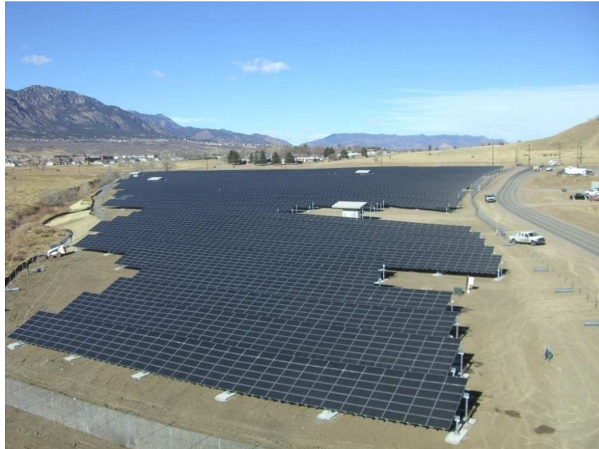
Figura 3.2 Arreglo de celdas fotovoltaicas de gran escala
