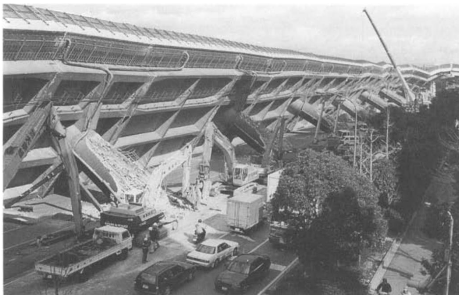
Figura 1.1 Falla por sismo en puente. (Priestley, Seible, & Calvi, 1996)
