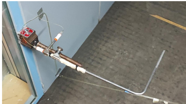
Figura 3.11 Tubo Pitot instalado
