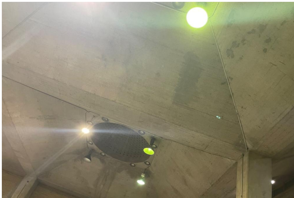
Figura 17. Foto 2 del registro fotográfico de las luminarias de haluro metálico instaladas.
