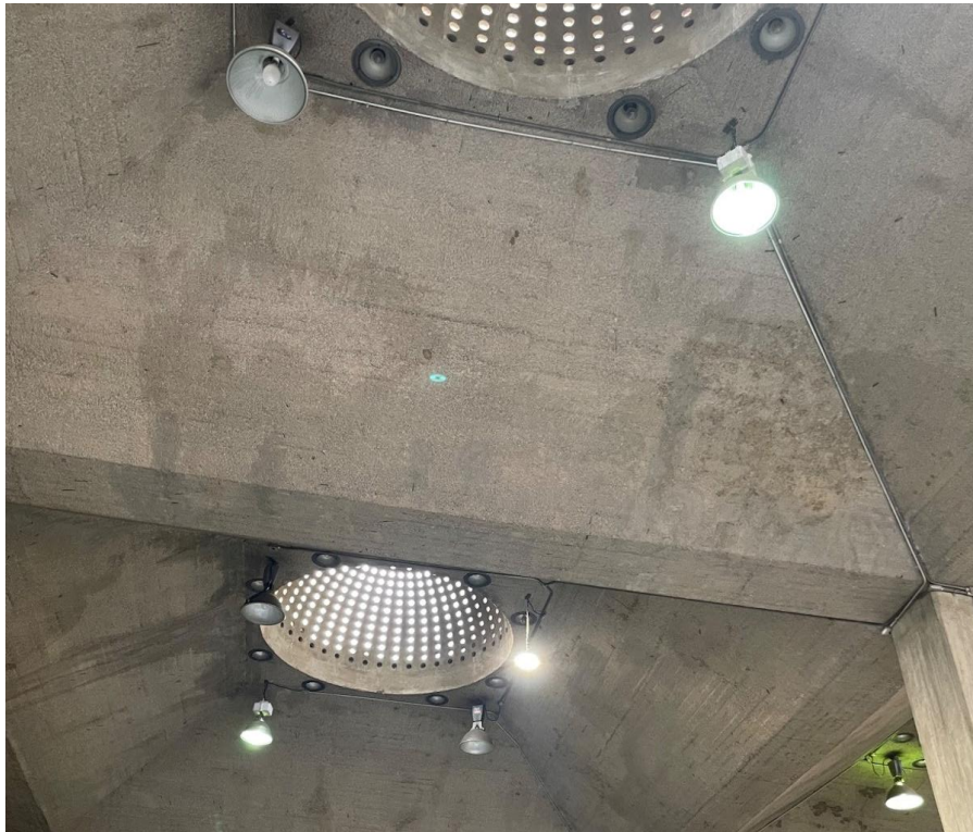
Figura 16. Foto 1 del registro fotográfico de las luminarias de haluro metálico instaladas.
