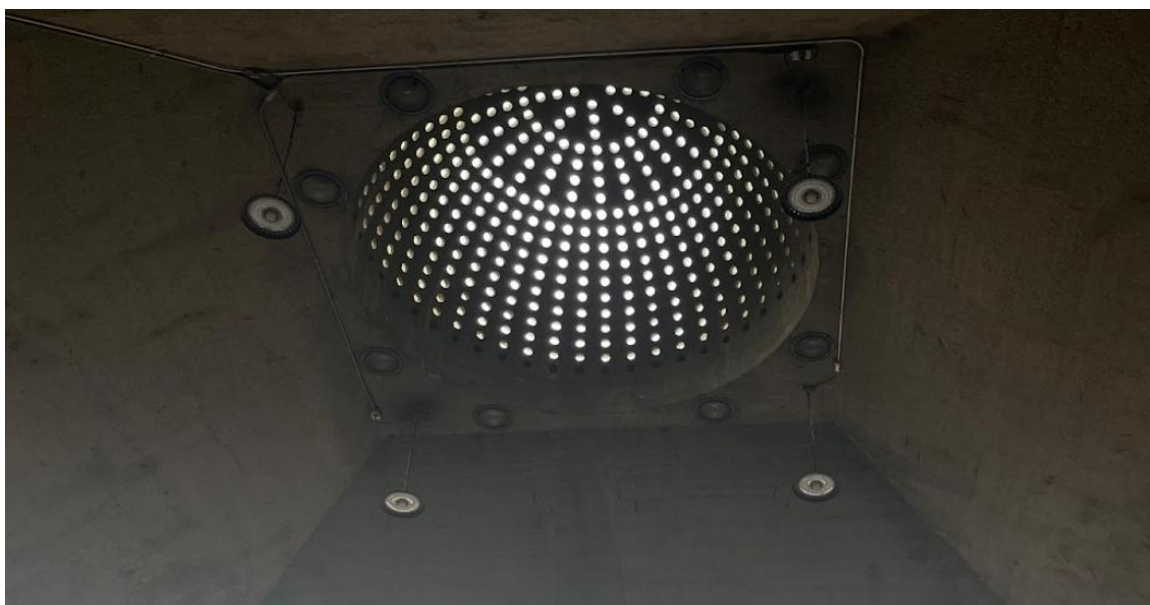
Figura 39. Foto 3 del registro fotográfico de las luminarias PLEP instaladas.
