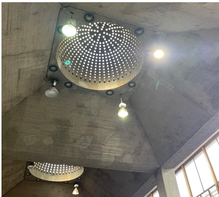
Figura 18. Foto 3 del registro fotográfico de las luminarias de haluro metálico instaladas.
