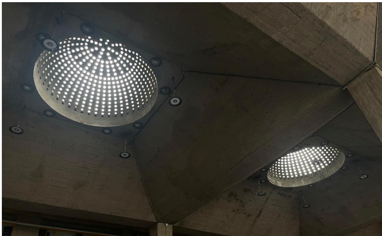
Figura 38. Foto 2 del registro fotográfico de las luminarias PLEP instaladas.
