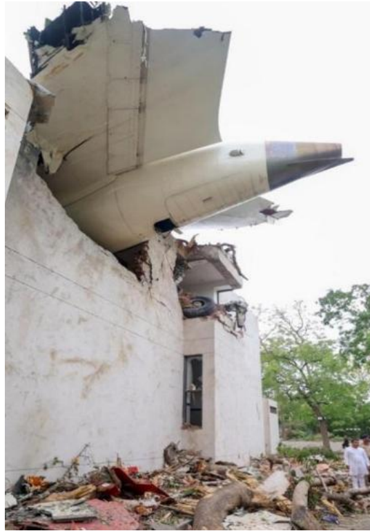
Figura 4. Sección de cola y Tren de Aterrizaje Principal incrustados en el edificio A. Tomada de [4].
