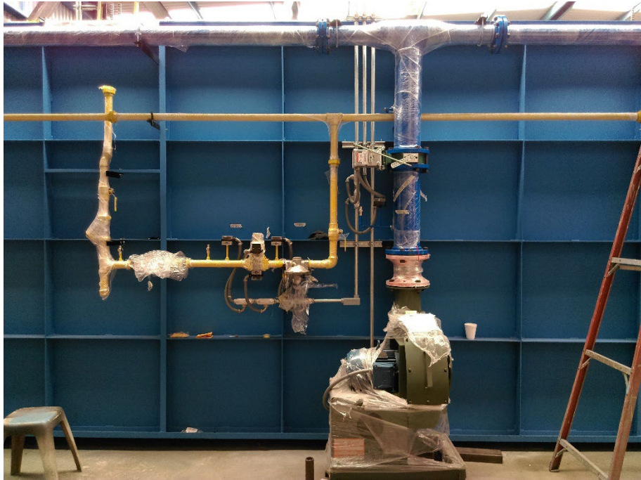
Foto 4. Sistema de combustión.
