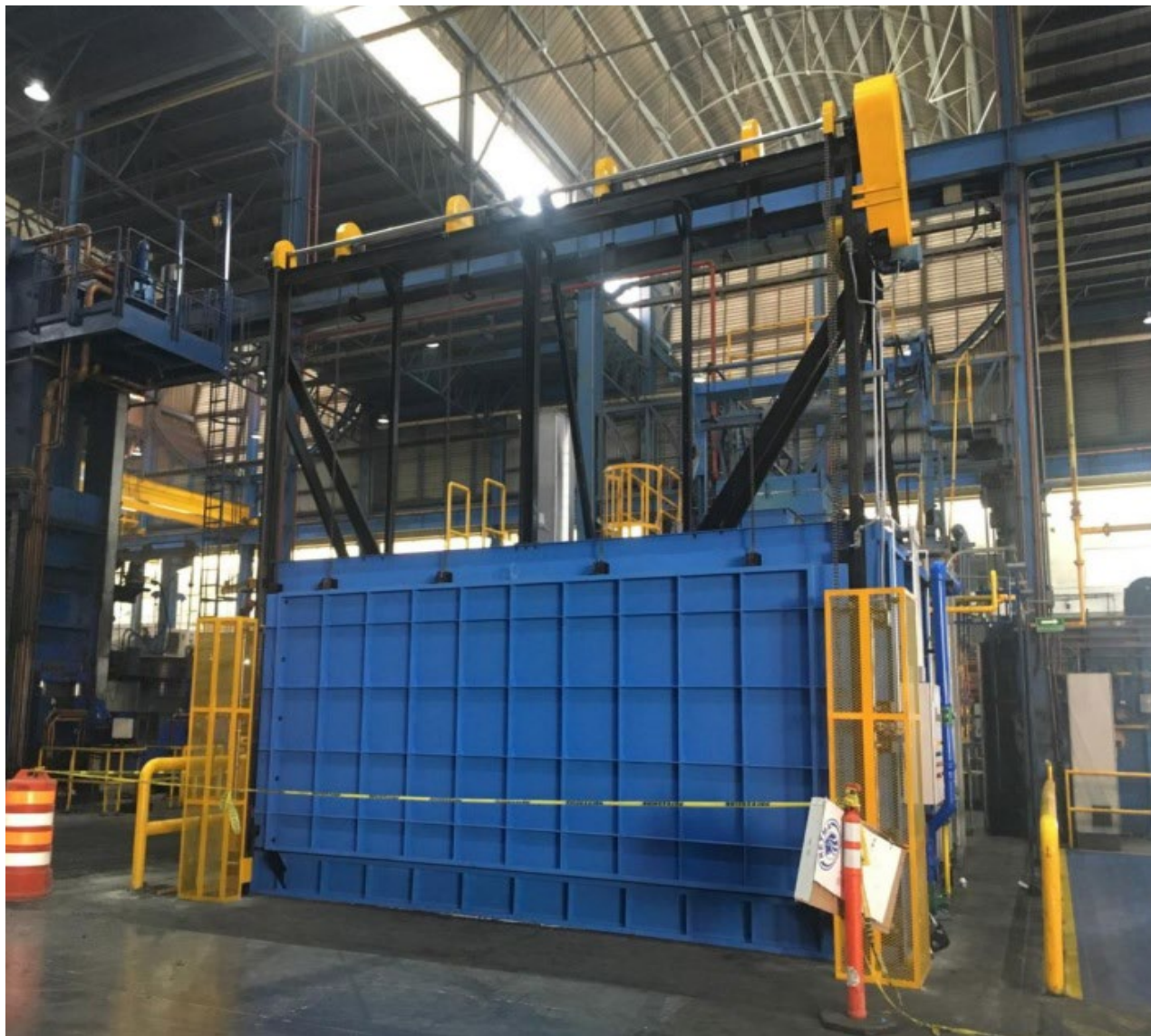
Foto 6. Horno de media temperatura, tipo Batch. Instalación en planta de cliente.
