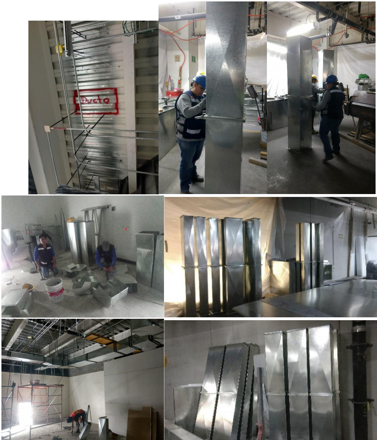
Figura 10B: Ensamble de ductos de lámina, de las diferentes secciones transversales y piezas de unión
