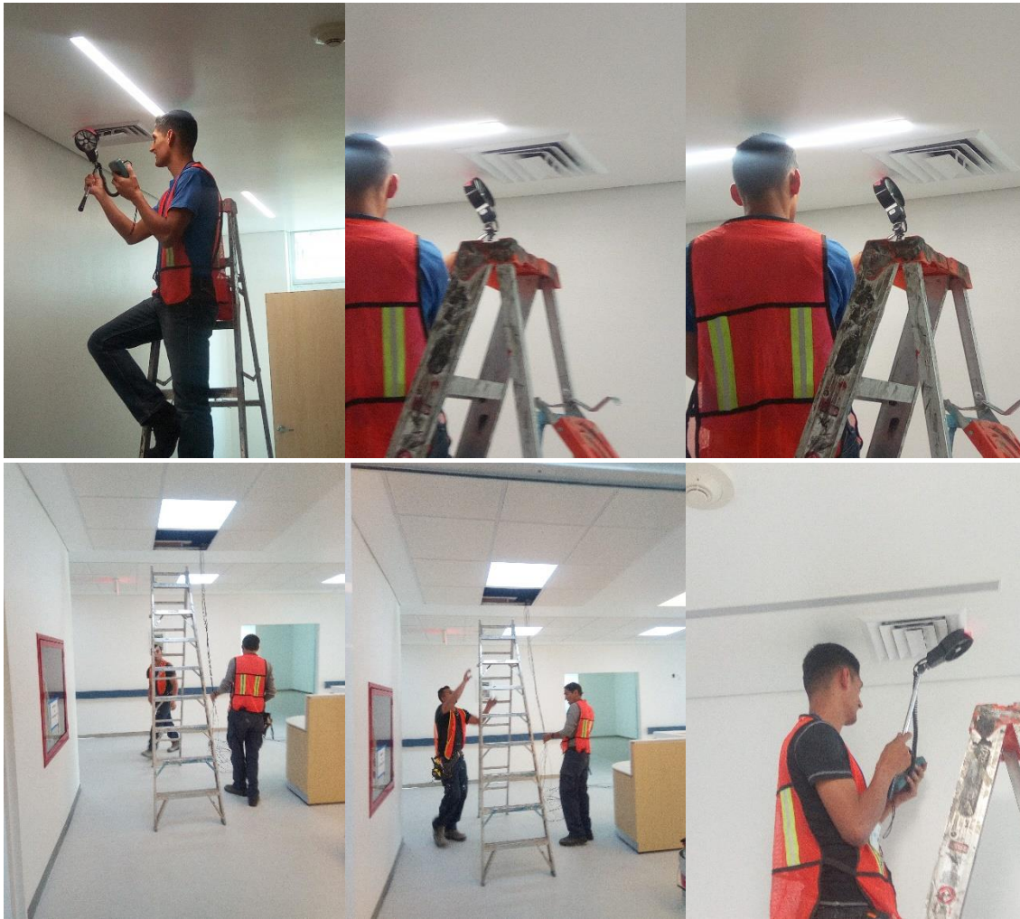
Figura 20: Calibración y regulación de salidas de aire
