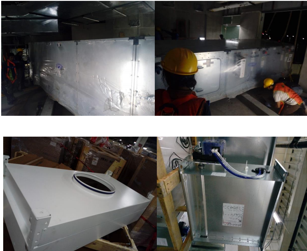
Figura 4: Elementos requeridos para la instalación y control del caso de estudio
