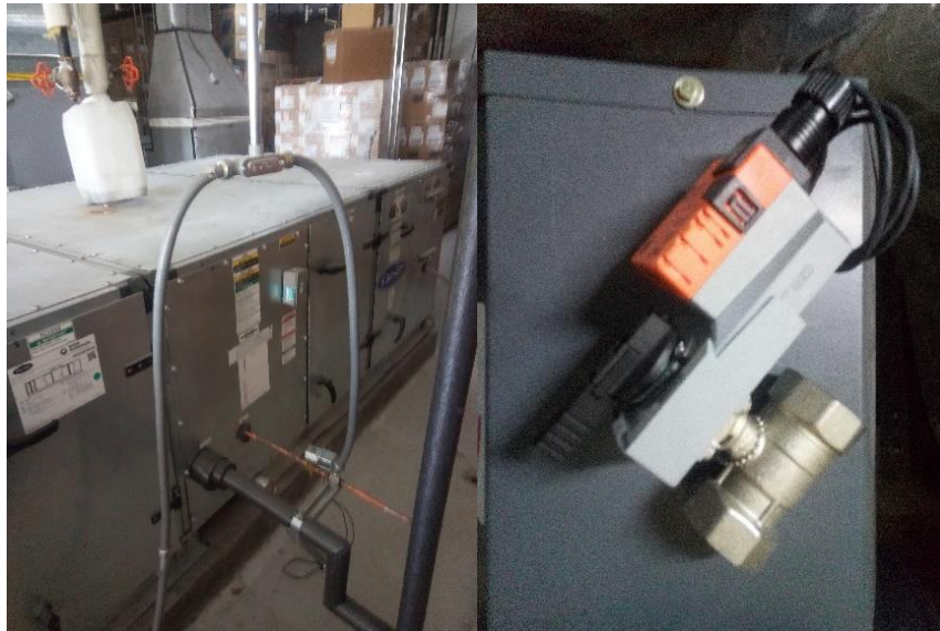
Figura 16 B: Actuadores mecánicos para el control de flujo de agua helada
