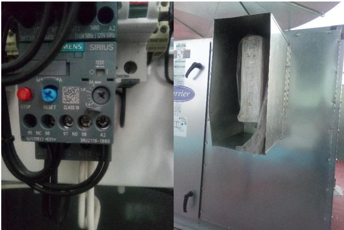
Figura 16E: Variador de frecuencias, para regular la apertura de las válvulas de agua
