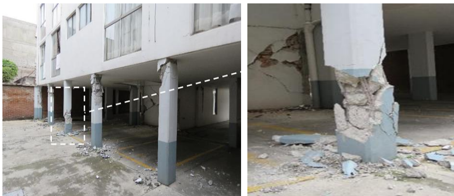
Figura 1.5. Edificación después del S19-2017, falla por planta baja débil (SÍSÉ, 2025).
