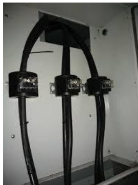
Figura 4.1 Transformador de instrumento de corriente tipo “Dona” y su conexión.
