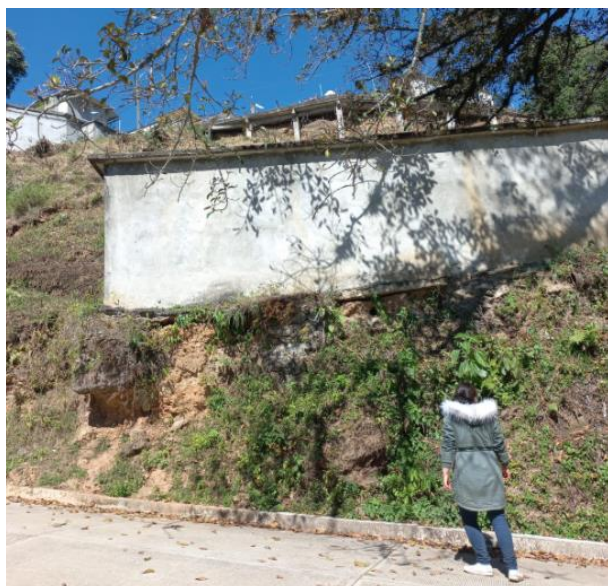
Figura 30. Falla del suelo donde se encuentra el tanque.
