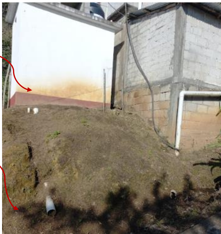
Figura 41. Sanitario con descargas hacia la calle.
