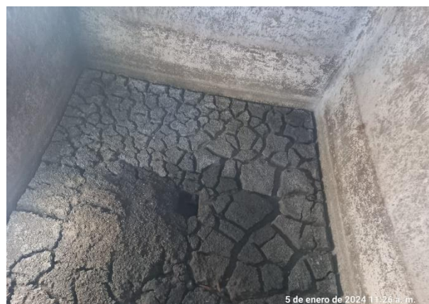
Figura 35. Condición interior de la segunda cámara séptica.
