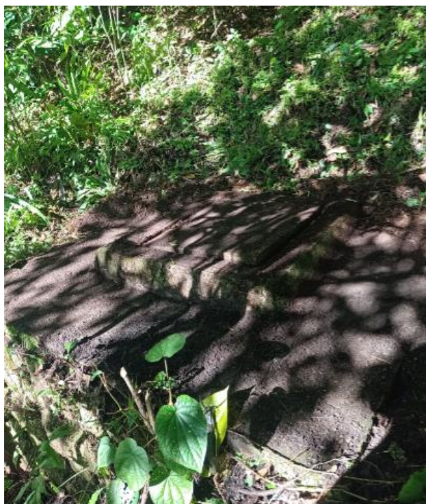
Figura 23. Tercera caja de conducción hacia el tratamiento.
