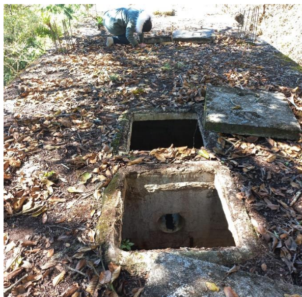
Figura 31. Condición exterior de la losa del tanque.
