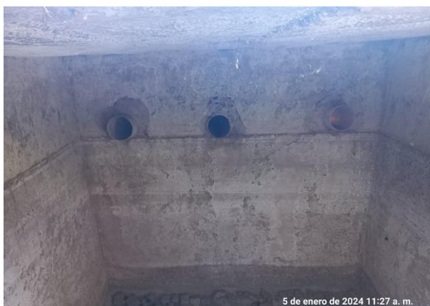
Figura 34. Condición interior de la primera cámara séptica.
