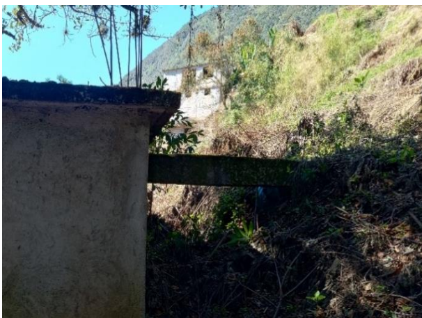
Figura 32. Tubería que conduce las aguas residuales al tanque de tratamiento.
