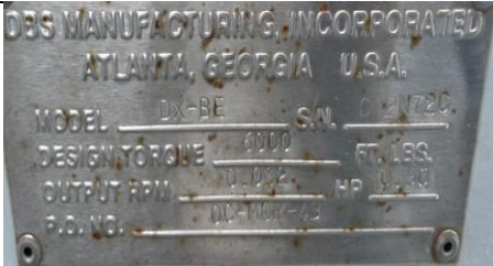
Figura 39. Placa del sedimentador secundario.
