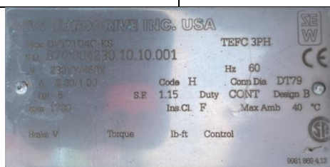
Figura 32. Datos de placa del motor eléctrico del espesador de lodos EL-1.
