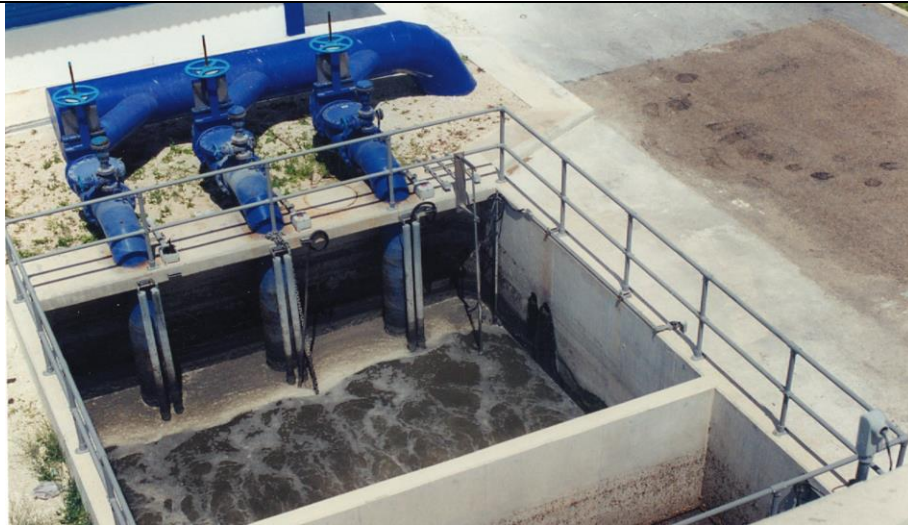
Figura 2. Cárcamo de bombeo de aguas residuales pretratadas.
