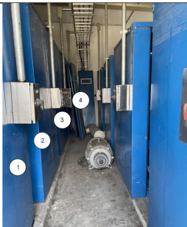
Figura 34. Vista general de los equipos sopladores de aire (los sopladores de la izquierda son para la línea de aire hacia el reactor biológico, los de la derecha hacia la línea de aire del digestor de lodos).
