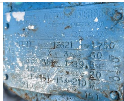
Figura 21. Vista de una de las bombas de cárcamo de 15 hp que se encontraba en fuera de operación por motivos de mantenimiento.
