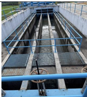
Figura 17. Compuertas y cribas de cada canal, con un rastrillo para la extracción de la basura.
