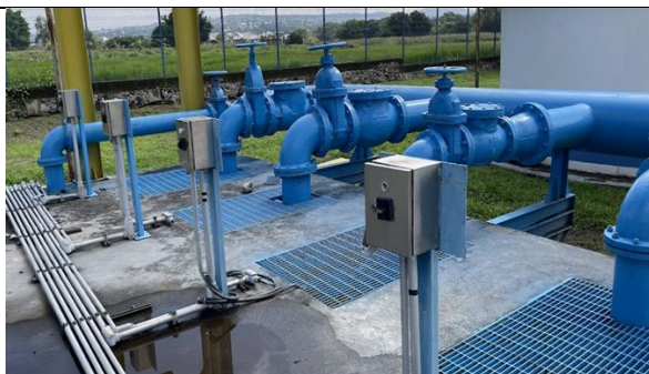
Figura 20. Vista general del cárcamo de bombeo y sus instalaciones mecánicas.
