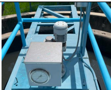
Figura 43. Vista del soplador de lodos EL-2, se muestra el sistema mecanizado.
