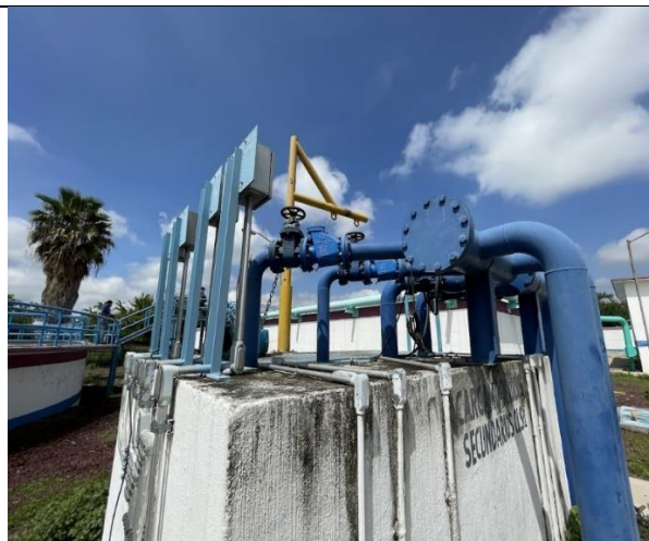
Figura 41. Bombas para el retorno del lodo secundario, desde el cárcamo de lodos hacia los reactores, la purga de lodos es enviada tanto al espesador de lodos primarios (EL-1) y al espesador de lodos secundarios (EL-2).
