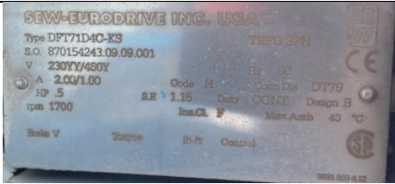
Figura 38. Vista del motor eléctrico del sedimentador secundario en funcionamiento continuo.
