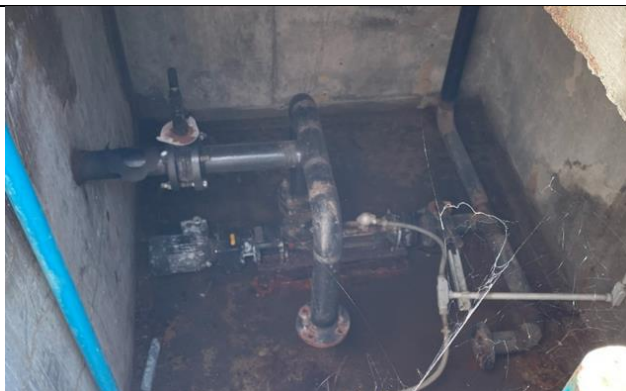
Figura 48. Instalación de equipo de bombeo de cavidad progresiva que envía el lodo digerido desde el digestor de lodos hacia el filtro banda, además tiene un bypass activo hacia el lecho de secado.
