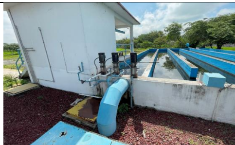
Figura 55. Vista del tanque de desinfección.
