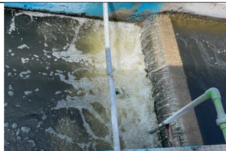
Figura 57. Actual sistema de desinfección por medio de pastillas de hipoclorito de sodio.
