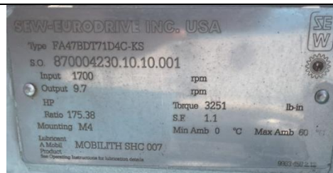
Figura 31. Datos de placa del motorreductor del espesador de lodos EL-1.
