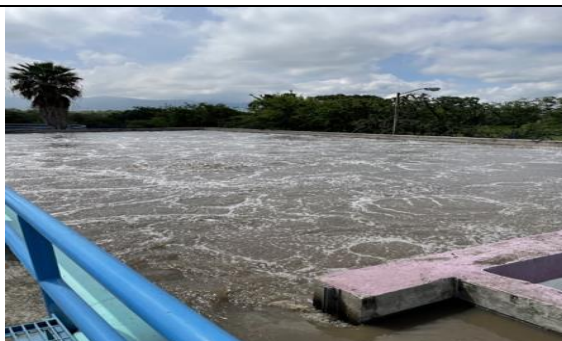
Figura 33. Vista del reactor biológico del tren 1 en operación.
