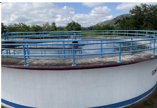
Figura 24. Vista del sedimentador primario.
