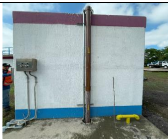
Figura 26. Bombas para el retorno del lodo secundario, desde cárcamo de lodos hacia reactores.
