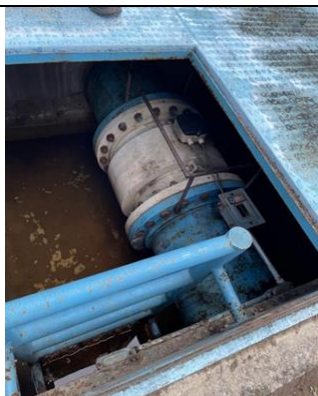
Figura 22. Vista del medidor de flujo en el registro.
