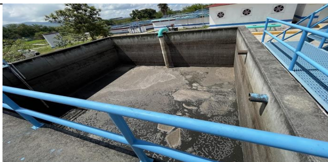
Figura 47. Vista del tanque de digestor de lodos.
