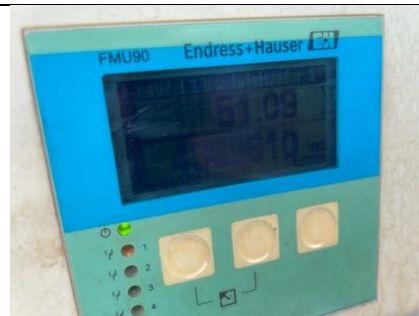
Figura 58. La medición de salida del agua tratada es a través de un canal Parshall, el cual tiene instalado un medidor ultrasónico, que en el momento de la visita daba una lectura de 51.09 l/s.
