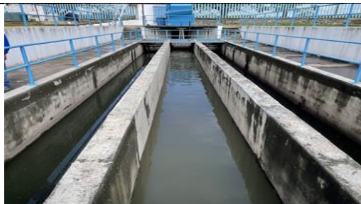
Figura 19. Vista de uno de los canales para el desarenado.
