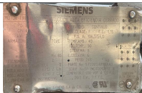
Figura 36. Datos de placa motor soplador de aire
