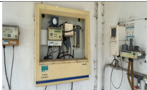
Figura 56. Anterior instalación del sistema de desinfección por cloro gas.
