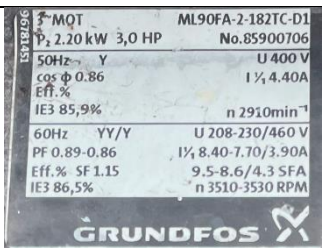
Figura 60. Placa del motor eléctrico del equipo de bombeo No.1.
