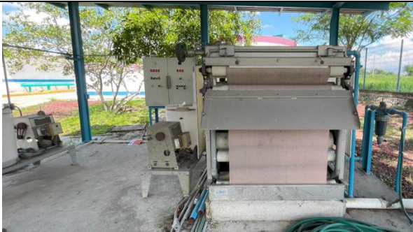
Figura 51. Vista del filtro banda actualmente sin condiciones de operar, el sistema de dosificación de polímero y tuberías están la mayoría instaladas.
