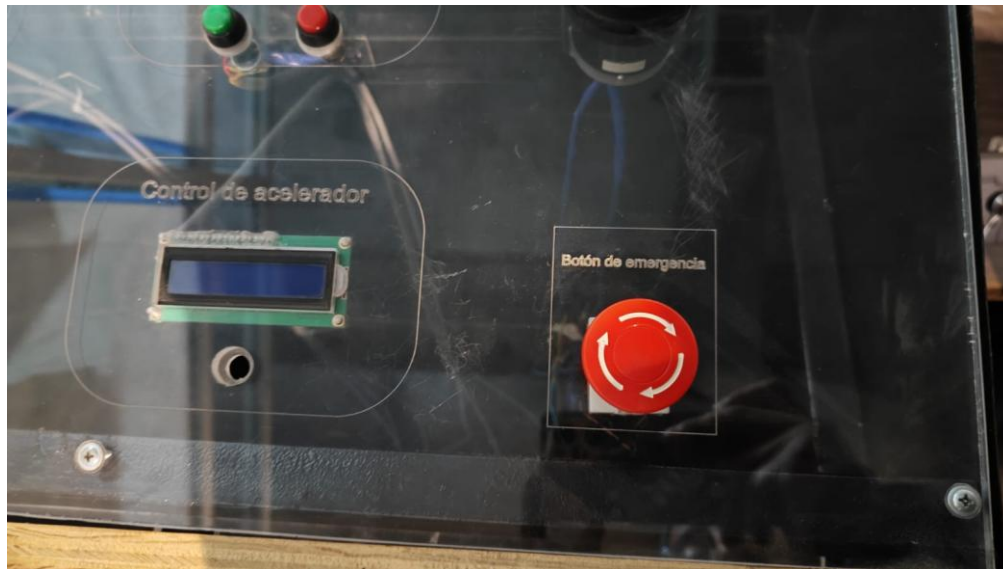
Figura 81 Botón de paro de emergencia ensamblado en el gabinete de resguardo de la instrumentación
