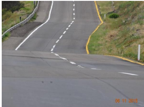
En la fotografía se muestra el nivel de daño y distorsión en la carpeta asfáltica. (Fotografía propiedad de TGC GEOTECNIA S.A de C.V, 2015)
