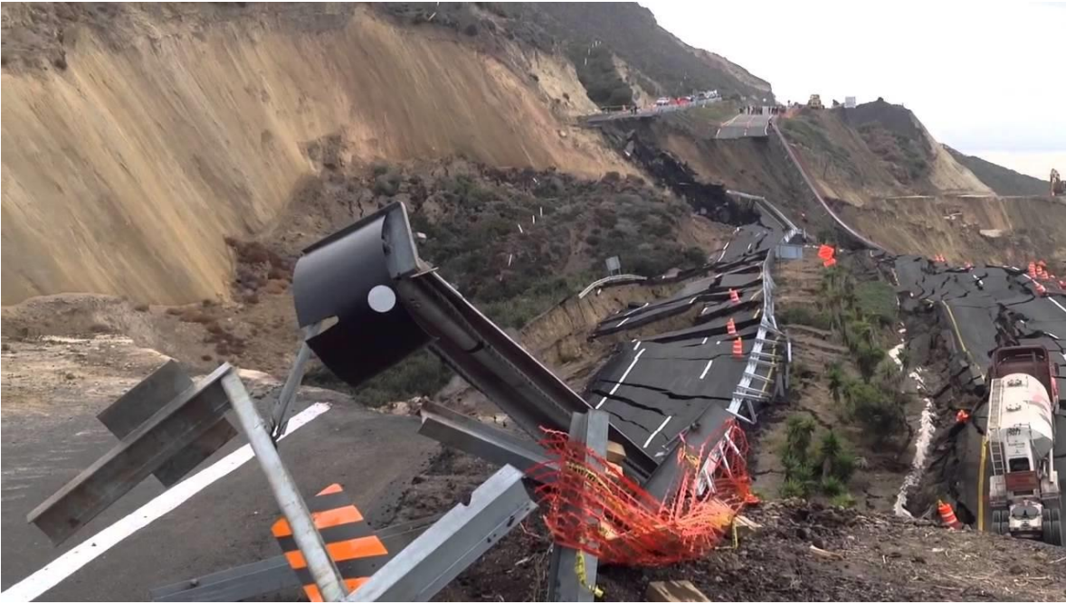
Imagen 5. Dimensiones del deslizamiento del año 2013 en la carretera Tijuana-Ensenada. Fotografía por Baja News, diciembre 2013
