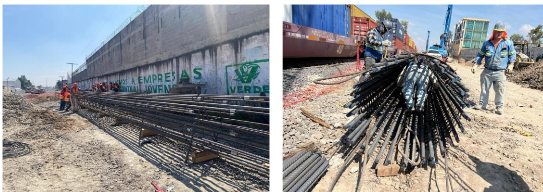
Imagen 45 y 46 Autoría Propia (2023) "Vista de conectores mecánicos roscados y sección transversal del armado de acero en sitio"
