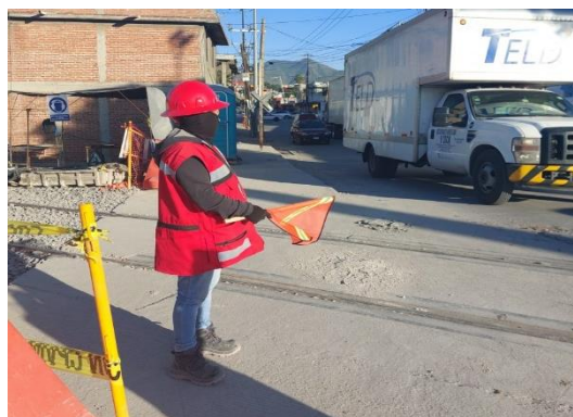
Imagen 165 Dozzer Construcción y Asesoría (2023) "Vista de bandereros en cruce a nivel de vehículos Viaducto 1"
