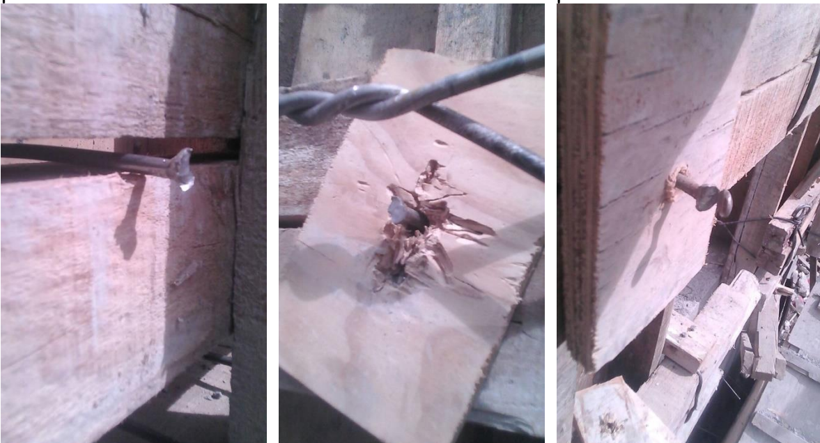
Fotografías V.2,12, 13 y 14 Falla de las cabezas de los moños en el troquel de la cimbra para muro
