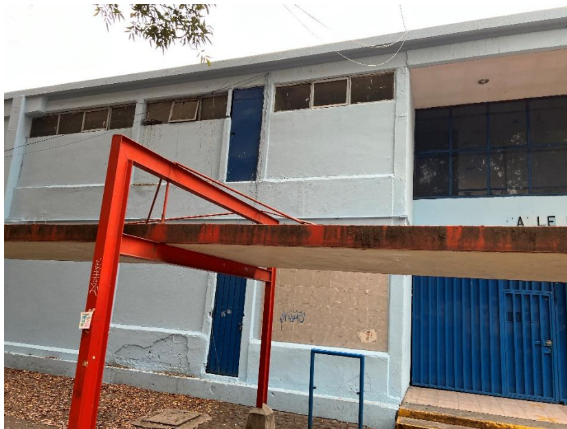
Fotografía 3 Muros bajos de Mampostería que generan el efecto de Columna Corta. Escuela Primaria Francisco Medina Asencio Alcaldía Cuauhtémoc [Fuente: Elaboración Propia]
