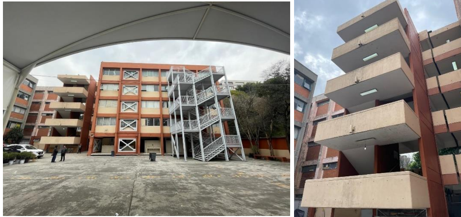
Fotografía 2 Cuerpo con contraventeos de acero en sentido longitudinal, cuerpo de escalera de concreto y de acero. Escuela Diurna No.187, Alcaldía Cuauhtémoc [Fuente: Elaboración Propia]
