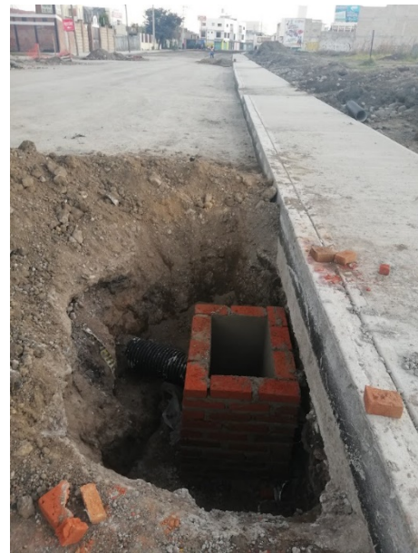
Foto 61. Registro para rejilla pluvial. Fuente propia.
