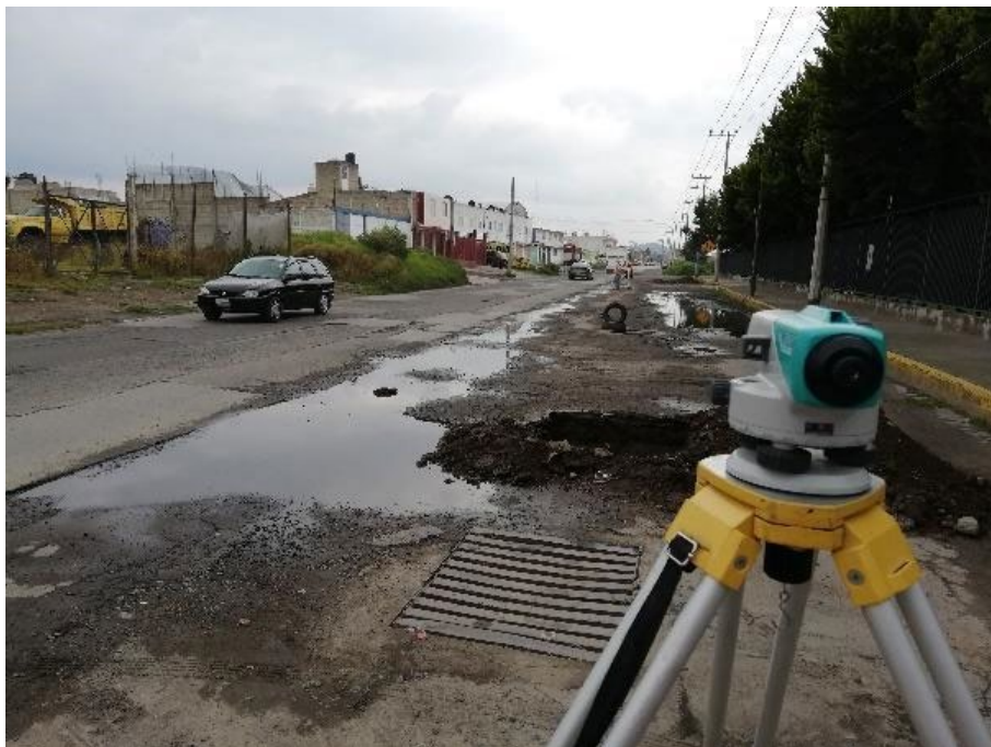
Foto 3. Vista de Av. Heriberto Enríquez dirección Toluca, se aprecia encharcamiento sobre su hombro derecho y rejilla de cáncamo azolvado hecho por iniciativa privada. Fuente propia.
