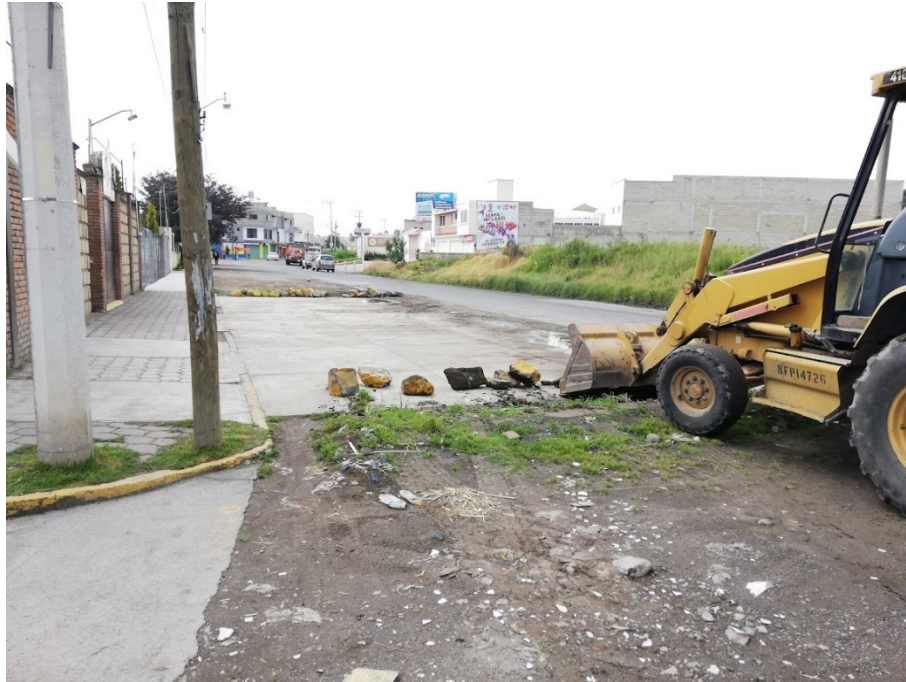
Foto 11. Av. Heriberto Enríquez esquina calle Pino, se observa firme de concreto colocado por un vecino. Fuente propia.
