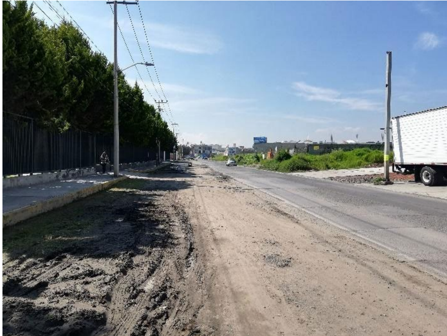
Foto 2. Vista de Av. Heriberto Enríquez dirección San Felipe Tlalmimilolpan, se aprecia falta de pavimento y lodo sobre su hombro izquierdo. Fuente propia.
