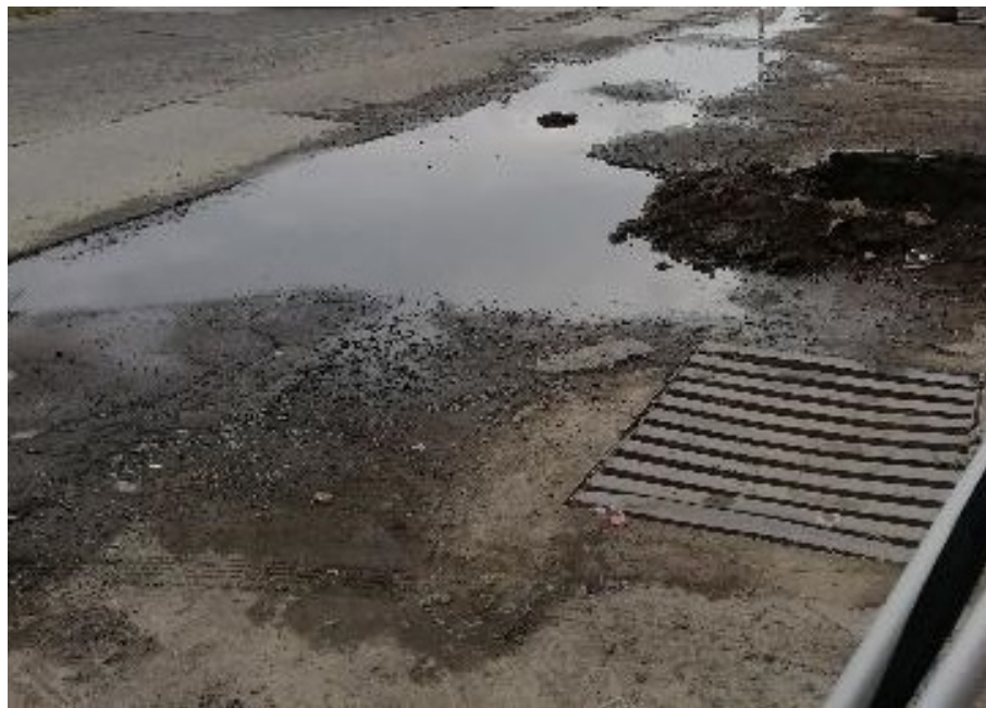
Foto 6. Av. Heriberto Enríquez frente a Instituto México, se observa cárcamo con rejilla, trabajo hecho por la institución. Fuente propia.
