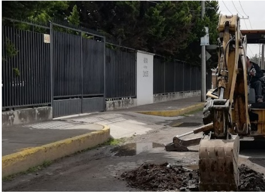
Foto 7. Av. Heriberto Enríquez frente a Instituto México, se observa cambio de altura de rampa de acceso. Fuente propia.
