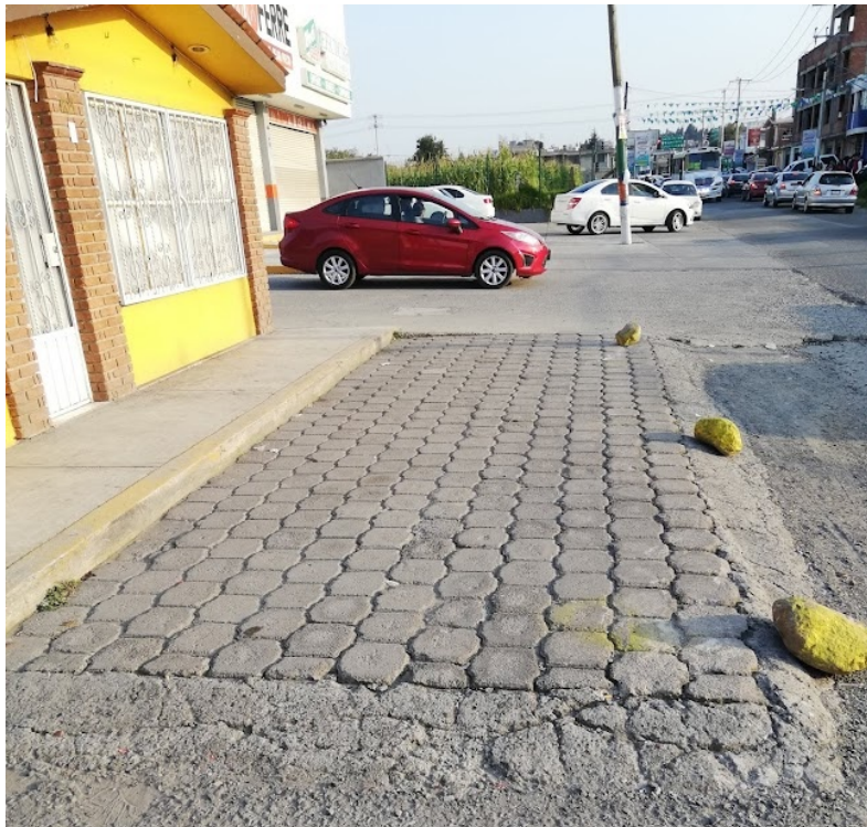
Foto 12. Av. Heriberto Enríquez esquina calle Unión, se observa piso de adoquín colocado por un vecino. Fuente propia.
