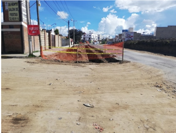
Foto 91. Confinamiento de zonas de riesgo. Fuente propia.
