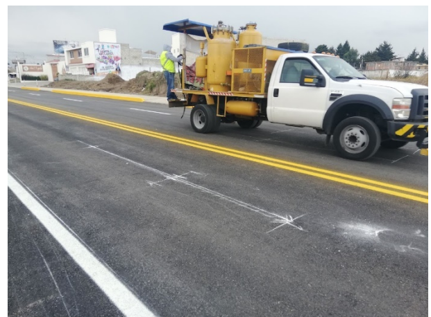
Foto 88. Camión pinta- rayas. Fuente propia.
