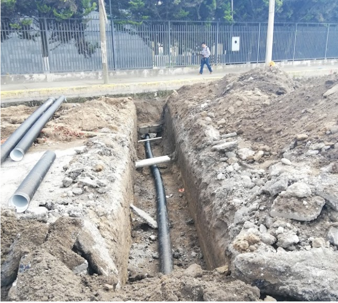
Foto 52. conexión de tubo PAD para drenaje sanitario, se observa que debe pasar por debajo de tuberías existentes. Fuente propia.
