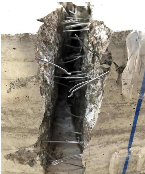
Figura 4. 124. – Detalle de falla de viga V2-2247 después de llevarla a la falla. Foto tomada por Bibian I. Silva.
