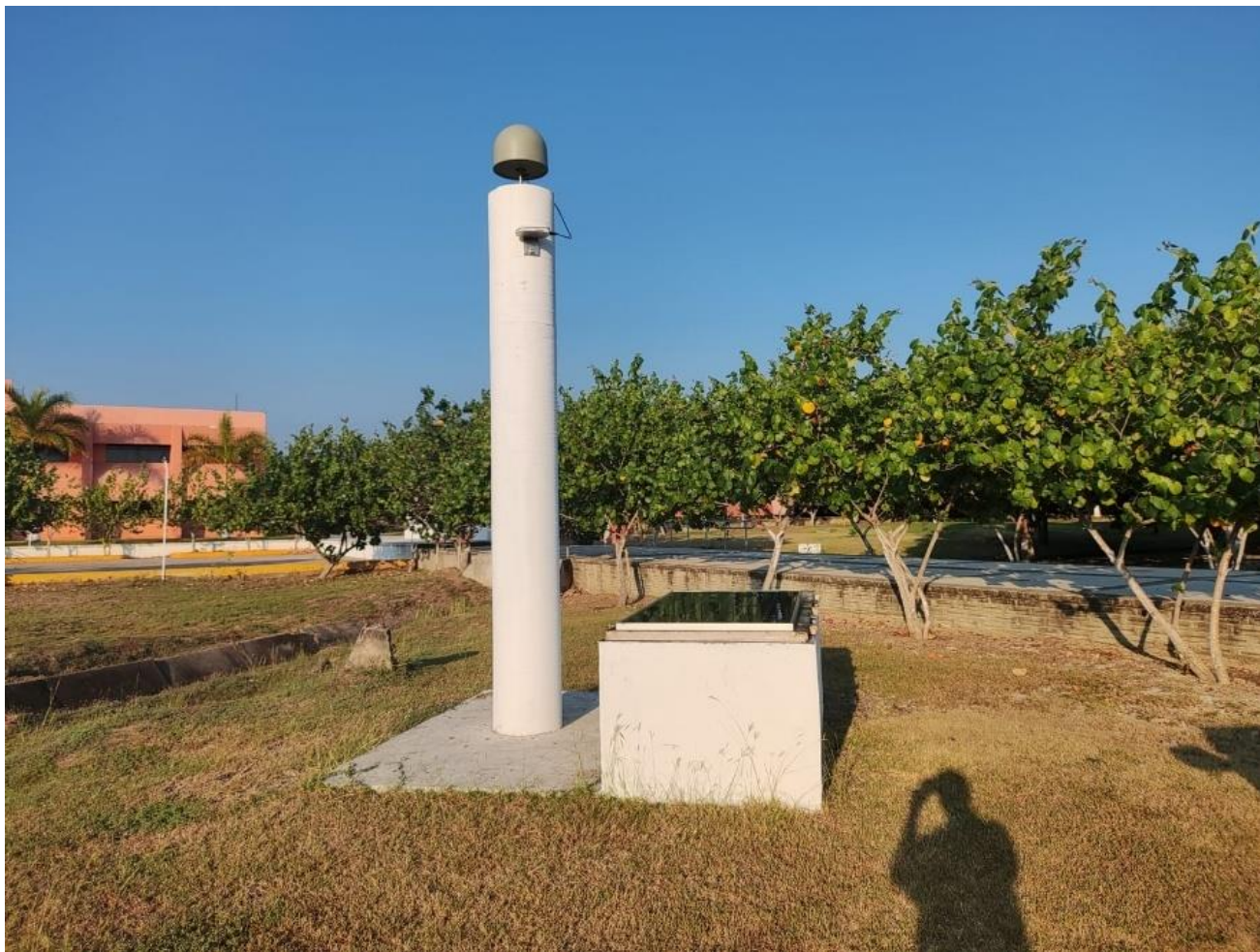
Figura 4: Fotografía de la estación KUTC ubicada en Petatlán, Guerrero. En ella se muestra una columna que contiene la antena GNSS y el enlace satelital. De lado derecho se aprecia una caseta en donde se halla el Kestrel, las baterías y el controlador de energía solar, el cuál proviene de un panel solar ubicado en la tapa.
