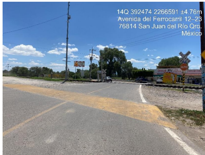
Figura 29 - Estado de la superficie de rodamiento (en dirección La Llave).
