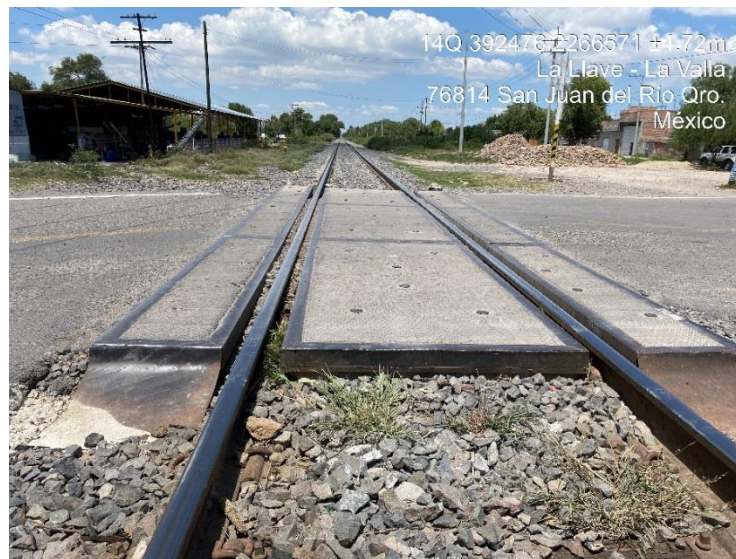
Figura 27 – Estado de la losa de concreto en el cruce a nivel.
