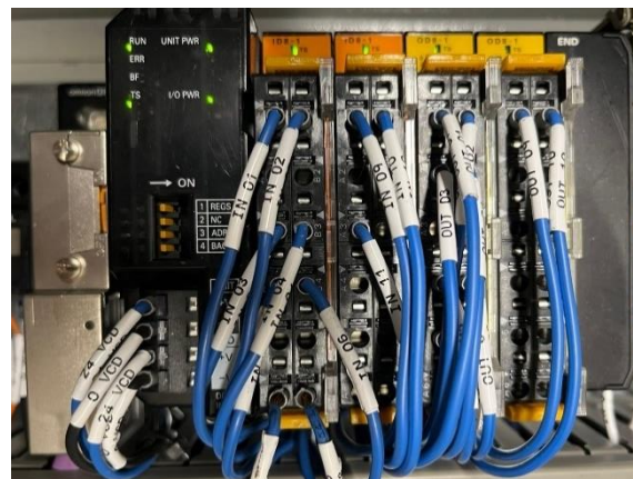
Imagen 2.12. Modulo remote fixture mesa 1 Tonale. Fuente. elaboración propia
