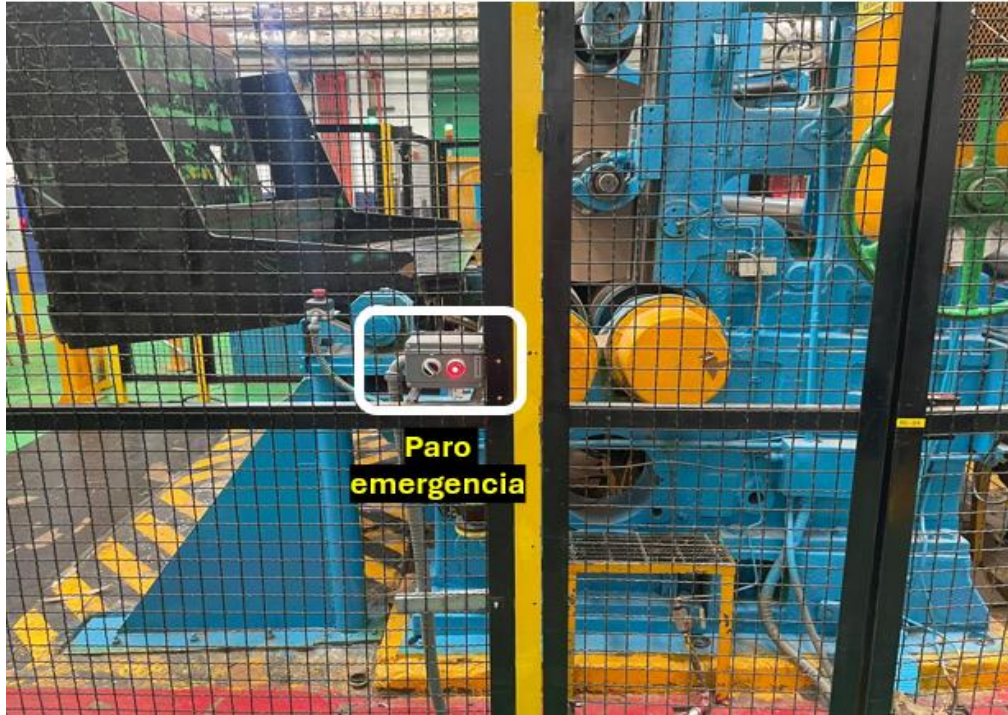
Imagen 3.27. Guarda de seguridades, paro de emergencia zona 3. Fuente. elaboración propia
