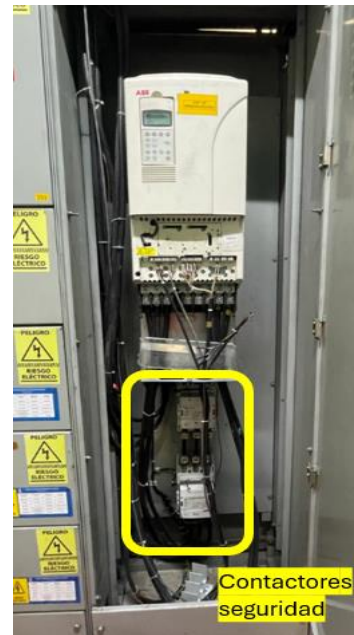
Imagen 3.35. Variador de velocidad bobinador. Fuente. elaboración propia
