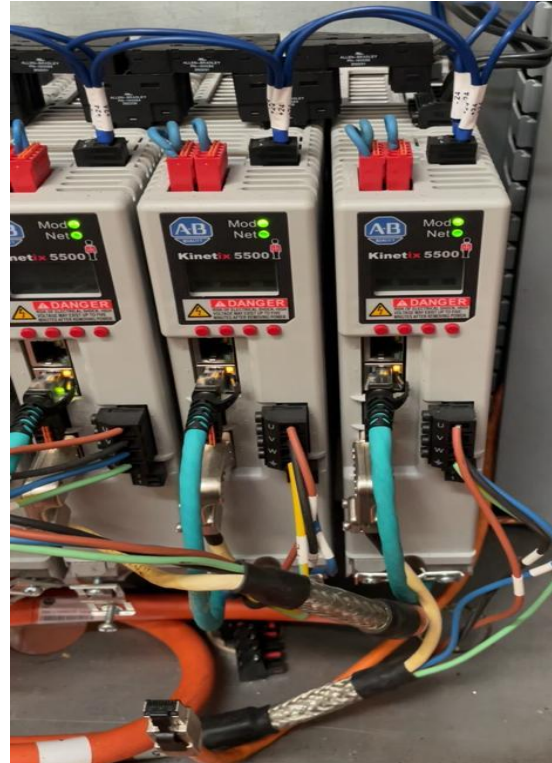
Imagen 5.8. Servodrive Kinetix 5500 Tren de alimentación. Fuente. elaboración propia
