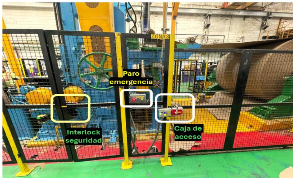
Imagen 3.26. Guardas de seguridad, interlock, caja de acceso, botonera Interlock de zona 3. Fuente: elaboración propia
