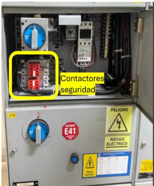
Imagen 3.34. Interruptor Extractor tiras y bomba hidráulica. Fuente. elaboración propia
