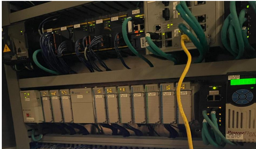
Imagen 4.7. PLC Manejo Fluinox Compactlogix L30ER. Fuente. elaboración propia
