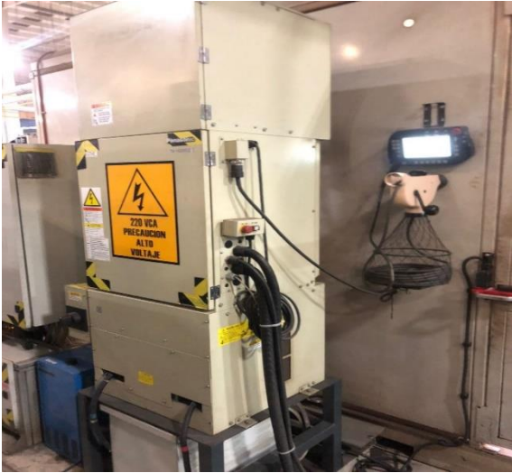
Imagen 2.4. Vista trasera (Controlador de robot). Fuente. elaboración propia
