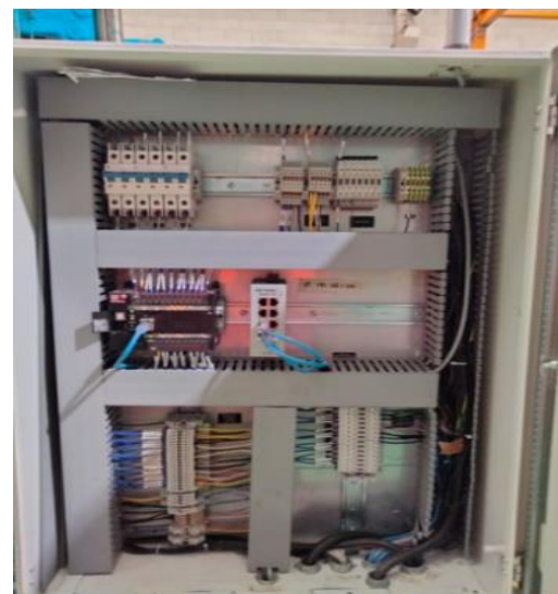
Imagen. 3.39. Tablero Zona 3. Fuente. elaboración propia
