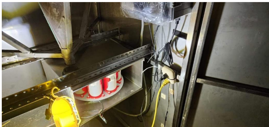
Ilustración 89. Instalación de Sistema de recolección de insectos. (Elaboración propia)
