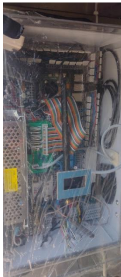
Ilustración 87. Gabinete de control de todo el sistema. (Elaboración propia)
