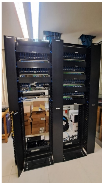
Figura 3.11.2.1 Rack de la DGPO.
