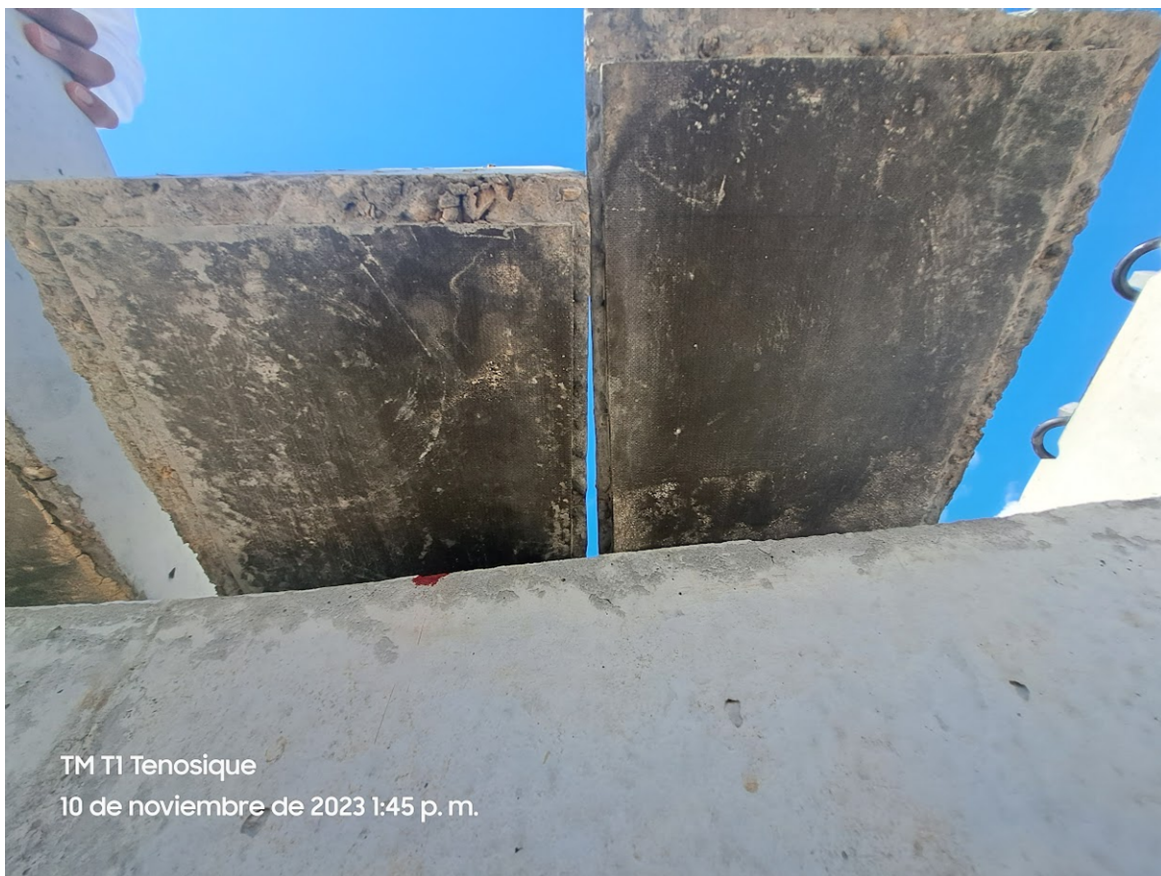
Figura 5.12. Durmientes con suela bajo durmiente usados en viaducto. Tren Maya Tramo 1. Tenosique, Tabasco (noviembre 2023)
