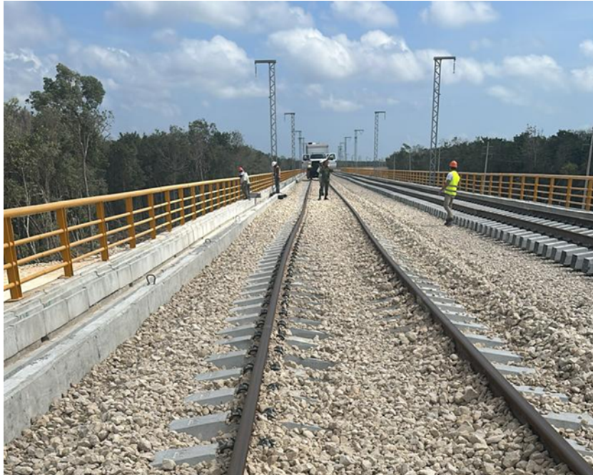
Figura 5.10 Chicoteo de vía producido por diferencia de temperaturas entre la unión de rieles y exceso de esfuerzos de compresión a los que está sometido el riel. Tren Maya Tramo 5. Playa del Carmen, Quintana Roo (febrero 2024)
