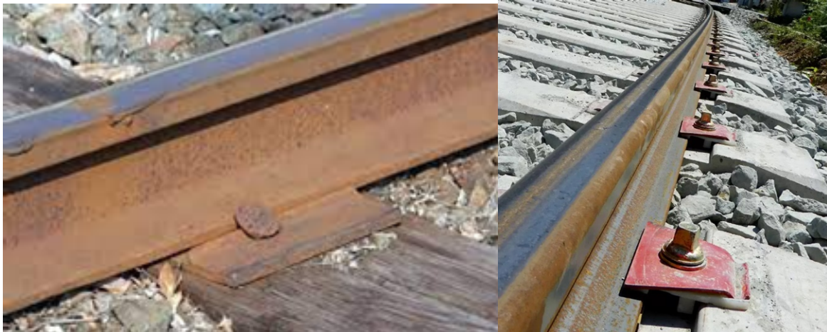
Figura 5.8. Sistemas de fijación convencionales, a la derecha, clavos con placas y durmientes de madera, a la izquierda, fijación Nabla. Patios de maniobras de Ferrovial, Tlalnepantla, EdoMex (septiembre 2022).
