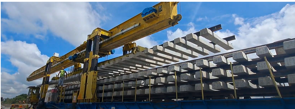
Figura 5.22 Izaje de escaleras sobre cama de balasto. Tren Maya Tramo 1. Balancán, Tabasco (octubre 2023)
