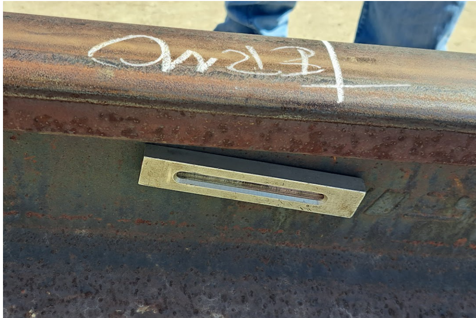
Figura 5.23 Medición de temperatura de riel para ejecutar los trabajos de liberación de tensiones. Tren Mexico-Toluca, Lerma, Estado de Mexico (septiembre 2022)
