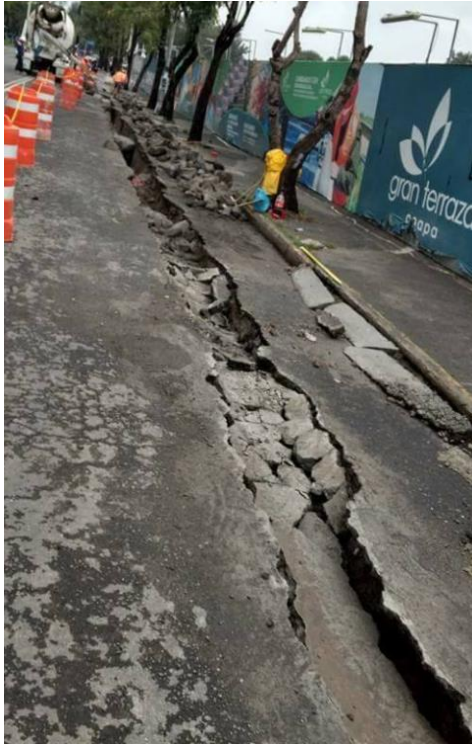
Figura 6. Grieta sobre avenida Acoxa en 2016.
