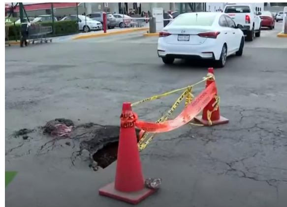
Figura 9. Socavón en Coapa. Agosto de 2023.
