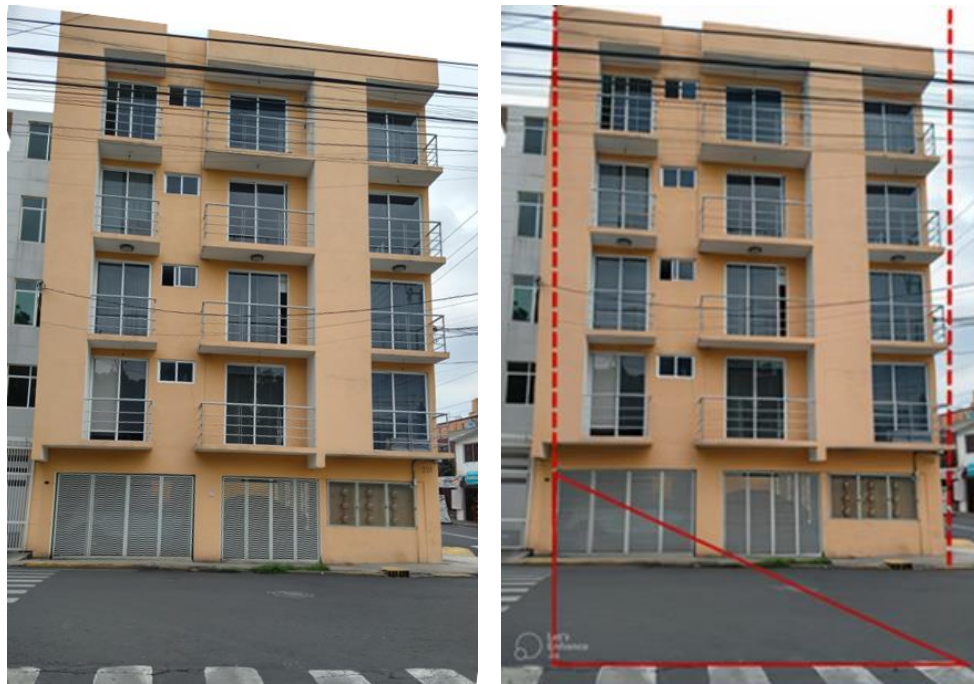
Figura 13. Edificio Salmón. Notoria inclinación hacia el edificio que se encuentra a la izquierda en la foto.
