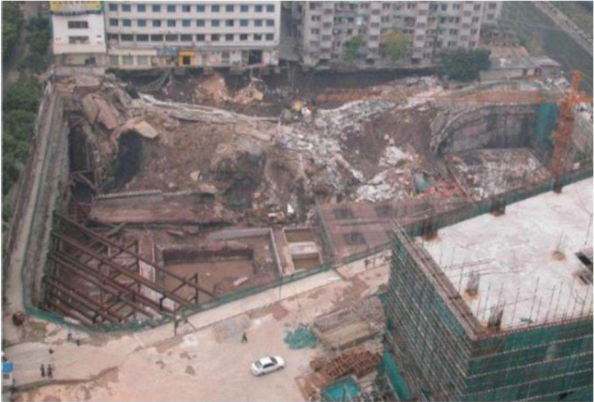
Figura I.10 Colapso de la cimentación en el lado sur (Zhang, 2022).
