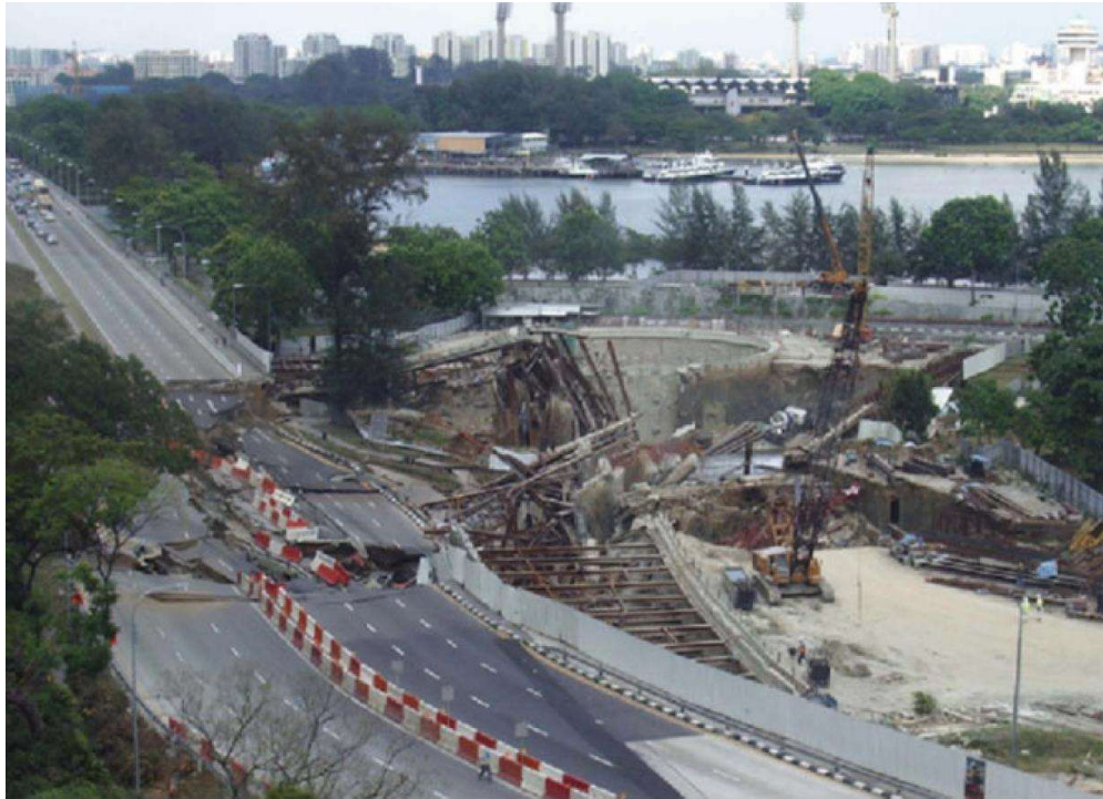
Figura 1.9 Terreno circundante de la excavación colapsada (Zhang, 2022).
