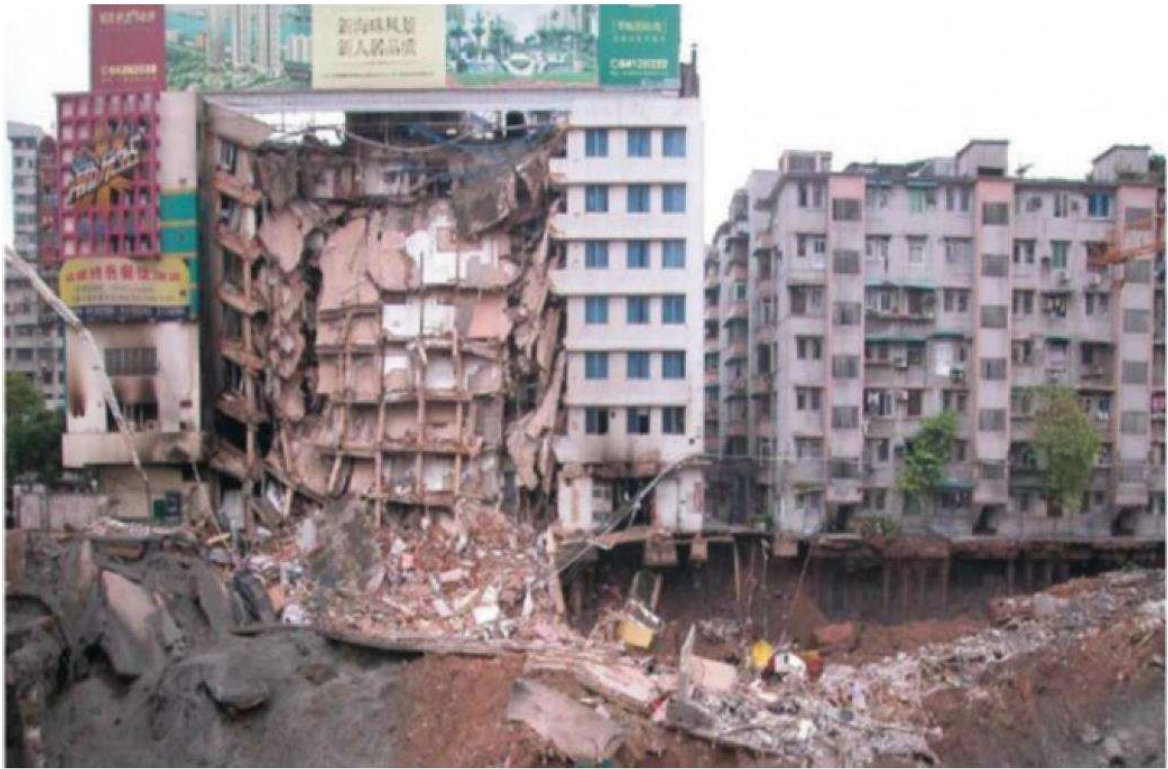
Figura 1.11 Colapso de cimentación Plaza Zhuhai (Zhang, 2022).
