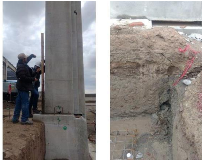
Ilustración 51. Afectaciones pluviales a elementos prefabricados.
