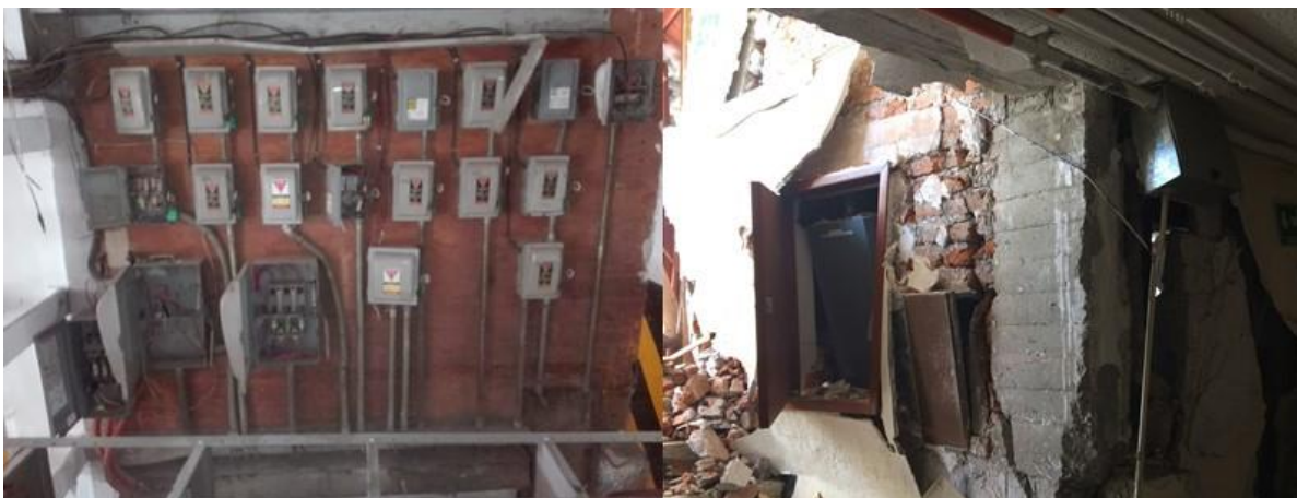
Ilustración 33 Ejemplo de instalaciones no detectadas previamente. Fuente Propia
