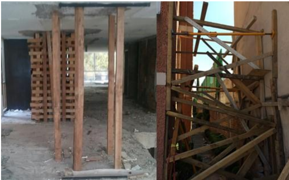
Ilustración 36 Ejemplo de refuerzo mal colocado o inseguro. Fuente Propia
