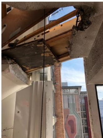
Afectaciones en la escalera
