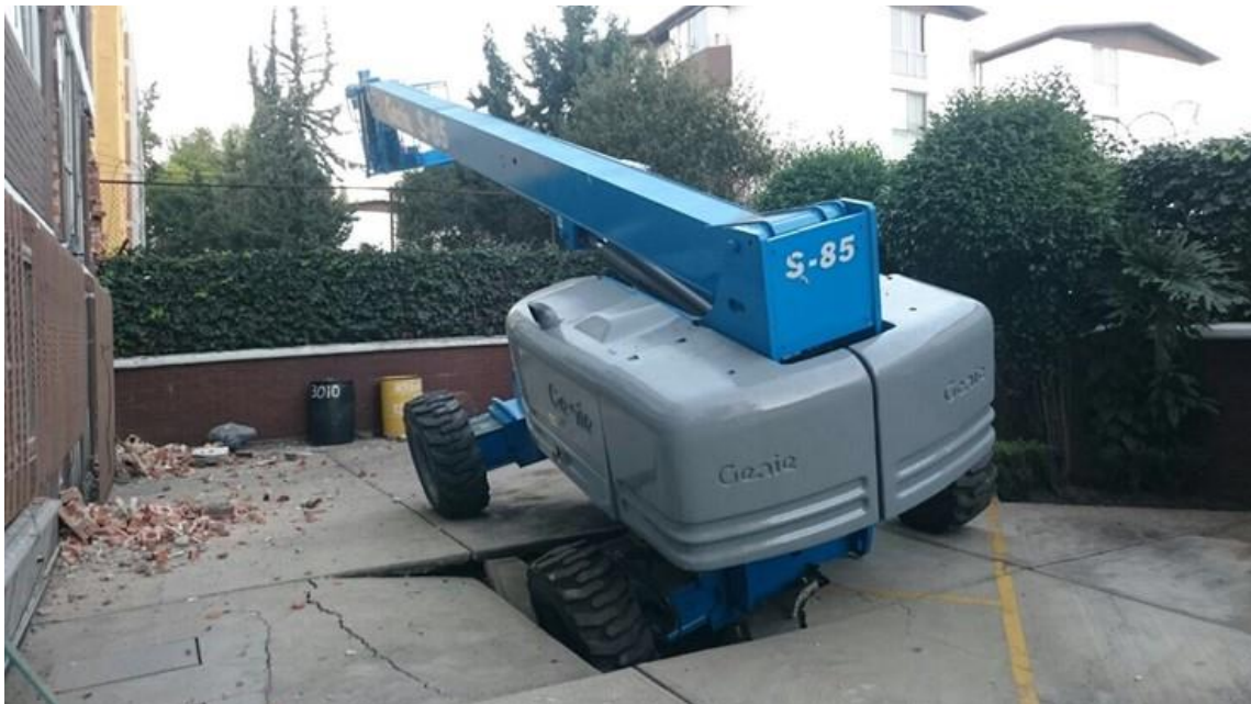
Ilustración 15 Daño causado por drenaje colapsado después del 19s Fuente propia
