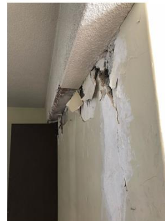
Afectación en muro divisorio
