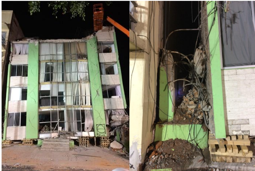
Ilustración 11 Daño por cortante con desplazamiento y colapso del inmueble Fuente propia
