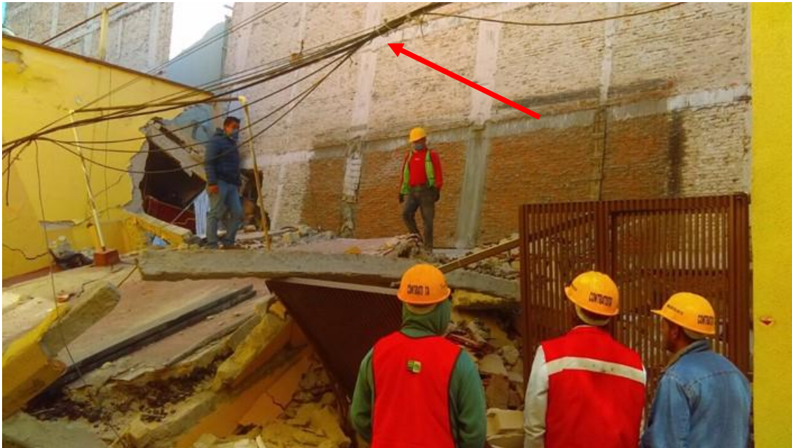
Ilustración 16 Instalaciones afectadas por el colapso de estructura Fuente propia
