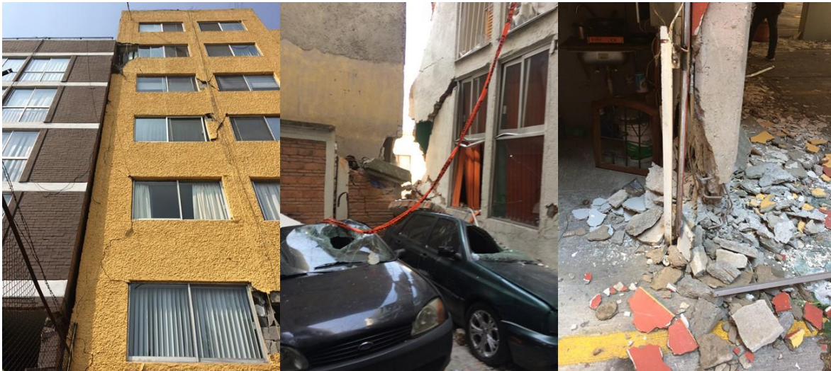
Ilustración 20 Daños presentados en la fachada y estructura Fuente propia
