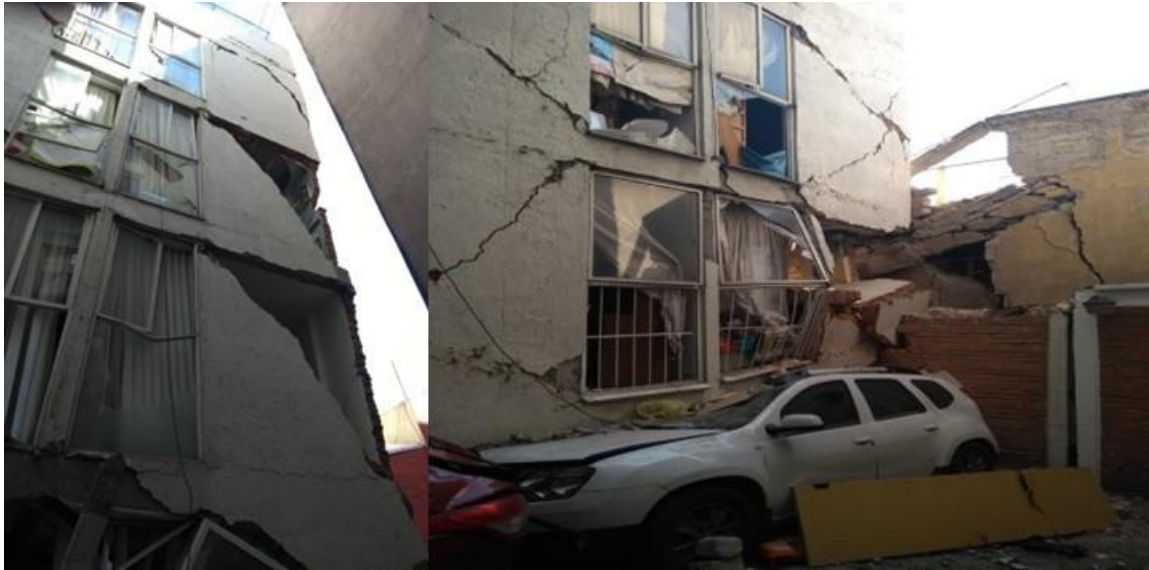
Ilustración 4 Daños en fachadas y estructura Fuente propia
