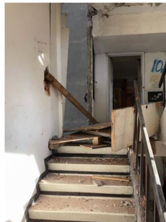
Afectaciones en la escalera (pasos)
