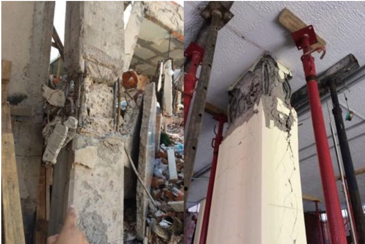
Ilustración 7 Daño por aplastamiento en columnas Fuente propia
