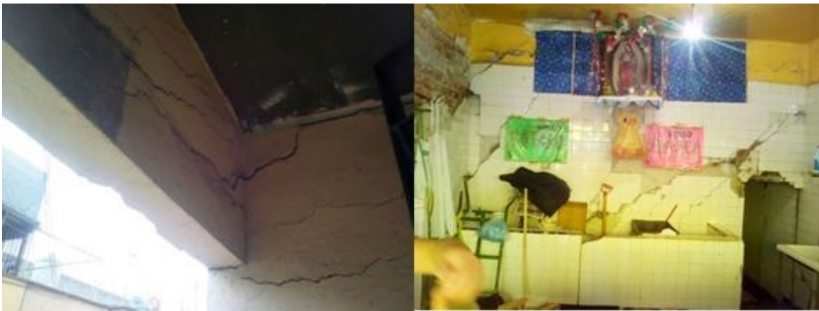
Ilustración 9 Daño por cortante entre inmuebles Fuente propia
