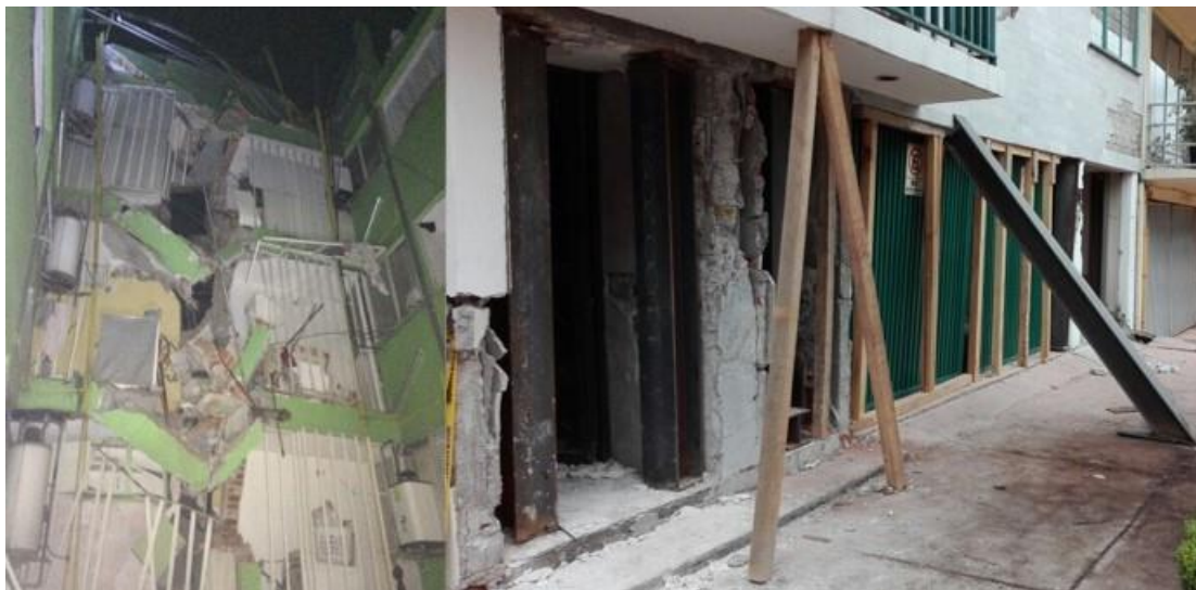
Ilustración 13 Estructura colapsada con elementos inestables Fuente propia
