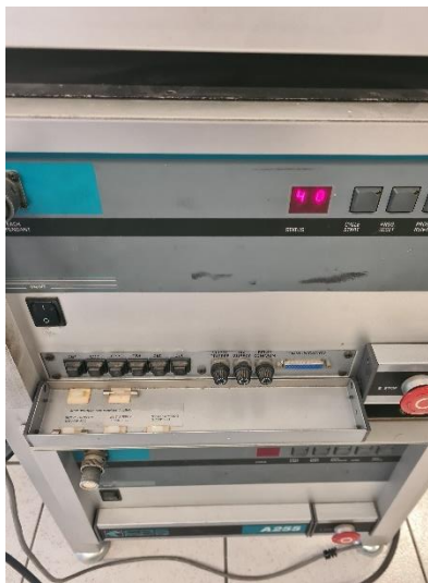
Ilustración 11: Panel de fusibles e interruptores de los controladores C500, el conjunto de seis cuadrados de color negro son los interruptores de corriente, mientras que a su derecha se observan tres tapas circulares donde se insertan los fusibles.
