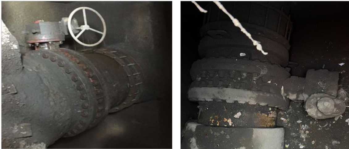
FIGURA 44 VÁLVULAS EXISTENTES ERMITA IZTAPALAPA ENTRE B. DOMÍNGUEZ Y J. O DE DOMÍNGUEZ (IZQ.). B. JUÁREZ Y TEZOZOMOC (DER.).
