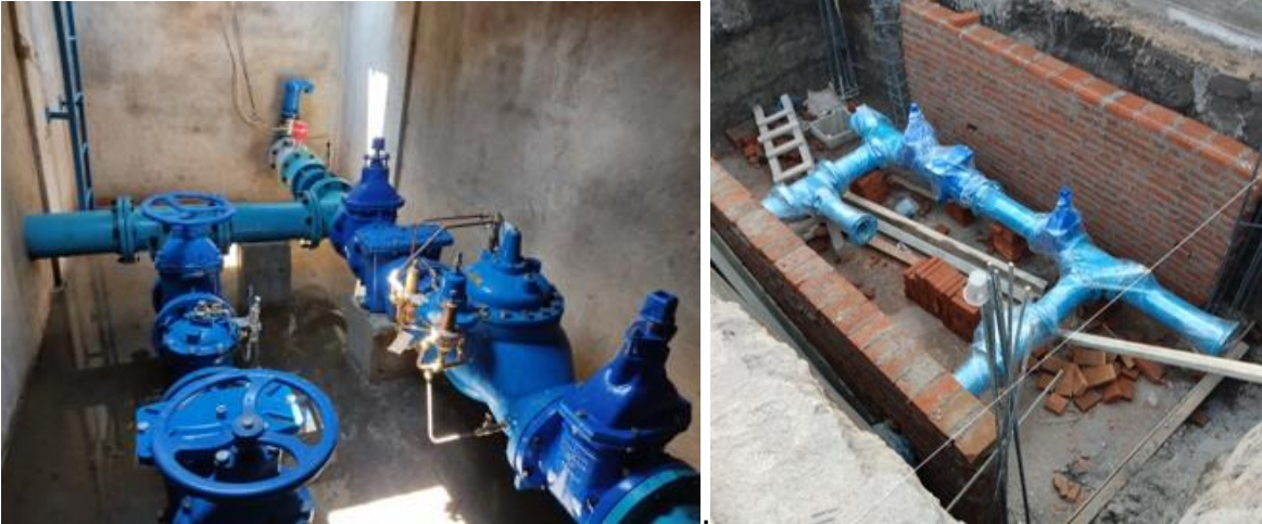
FIGURA 12 CAJAS DE MEDICIÓN DE GASTO Y CONTROL DE PRESIÓN EN ENTRADAS A LOS SECTORES.
