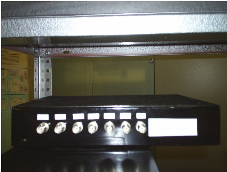
Figura I.12. Bloque de terminales de conexión
