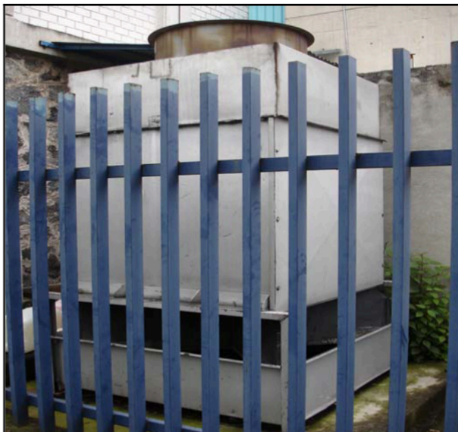
Figura 4.5 Torre de enfriamiento.
