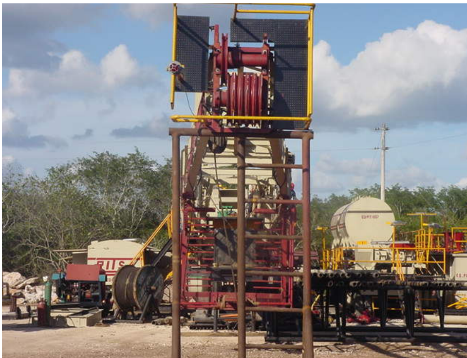
Fig.3.12 Diferentes tanques de almacenamiento de fluidos de perforación que se utilizaron
