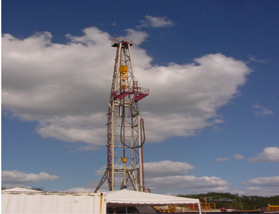
Fig. 3.8 La figura nos muestra a la torre de perforación así como a la polea viajera la changuera y la línea conductora del fluido de perforación utilizados durante la perforación del pozo Yaxcopoil-1
